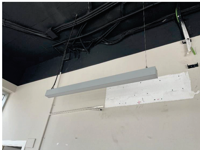
5.Sala: Lluminares en suspensió de 1m.
