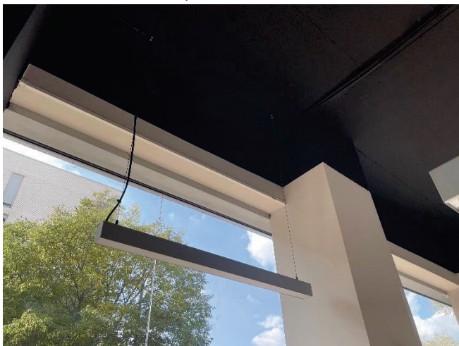
5.Sala: Lluminares en suspensió de 1m.
