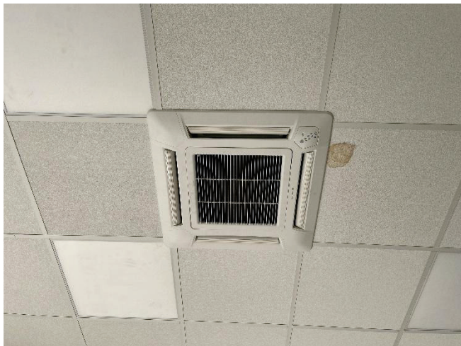
3.Despatx 02: Split aire condicionat encastat a fals sostre.
