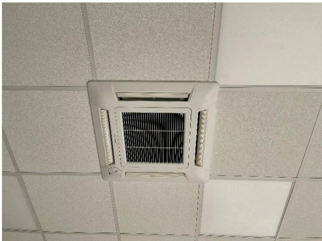
3.Despatx 01: Split aire condicionat encastat a fals sostre.
