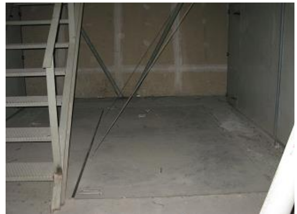
Foto 4. Trampilla de entrada de equipos en todas las salas técnicas sin líneas de vida o puntos de anclaje para uso de arneses de seguridad.
