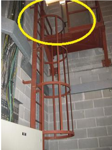
Foto 1. Desembarco desde escala a cubierta sin protección perimetral sobre la superficie de llegada.
