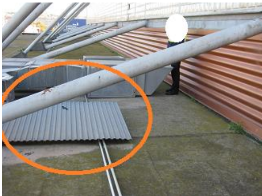
Foto 1. Hueco protegido con chapa no transitable con riesgo de caída altura superior a 2 m. sin señalar.
