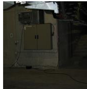
Foto 2. Varios cuadros eléctricos sin señalizar.
