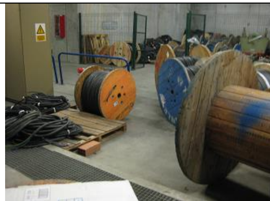
Foto 4. Bovinas y restos de materiales obstaculizando acceso a galería transversal 3.1.
