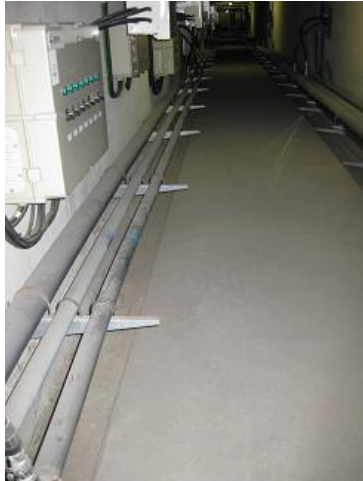
Foto 3. Soportes metálicos de sujeción que sobresalen a baja altura en zona de paso.
