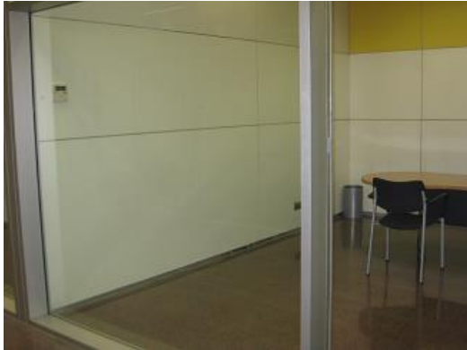
Foto 3. Tabiques acristalados como sistema de división de salas sin señalización o barrera que impida contacto con ello.
