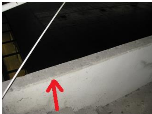
Foto 6. Muro perimetral en altillo lado CC3, en zona escalera con altura inferior a 90 cm.
