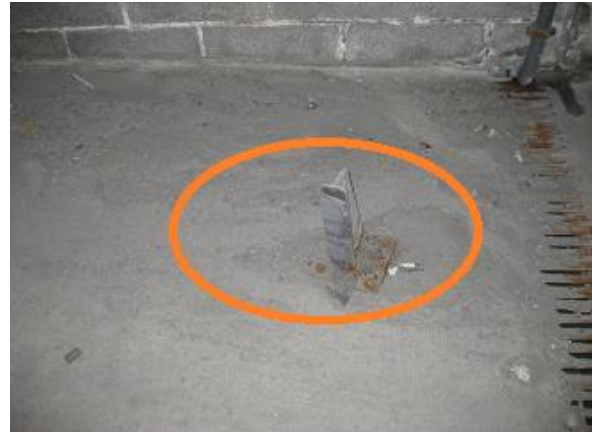
Foto 4. Soportes metálicos de sujeción de frenado de puerta de almacén de gastrofira.
