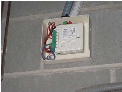
Foto 1. Caja de conexión eléctrica con cables al descubierto en nivel 0.
