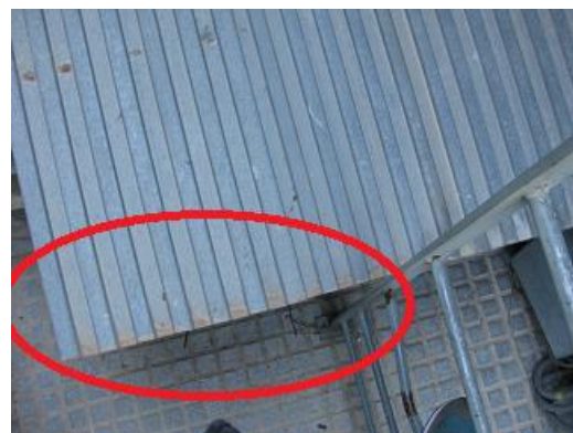
Foto 2. Chapa metálica cortante en desembarco de escala desde cubierta.
