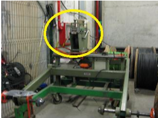
Foto 1. Extintores y BIE obstaculizados detrás de la desenrolladora de cable.
