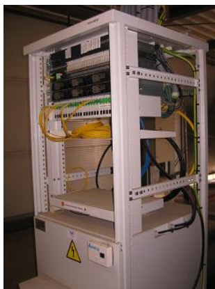
Foto 1. Cuadro eléctricos de equipos en todas las salas sin tapas.
