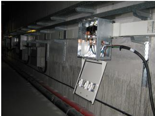
Foto 1. Cuadro de conexiones eléctricas abiertos con embarrado al descubierto en alguna galería transversal.
