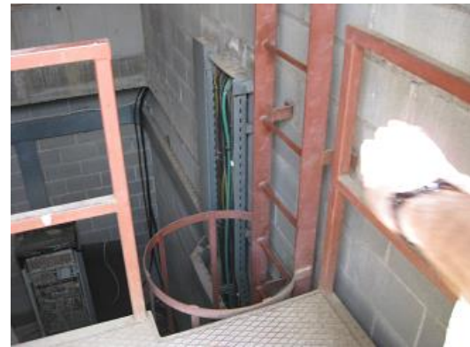
Foto 2. Vista desembarco de escala desde cubierta sin jaula de protección sobre superficie de llegada.
