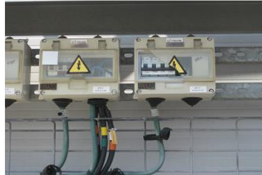
Foto 4. Cuadro eléctrico exterior de sala SM2.5 con tapa de protección rota quedando expuesto a lluvia.
