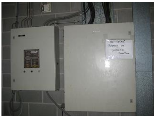
Foto 3. Cuadros eléctricos sin señalización.
