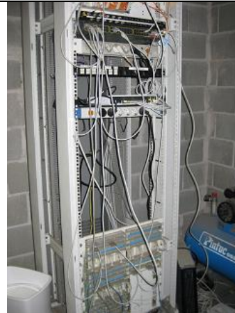
Foto 2. Cuadros de telecomunicaciones con conexiones eléctricas sin protecciones.
