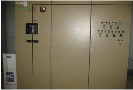
Foto 3. Cuadros eléctricos de transformación sin señalización en las 8 salas técnicas.
