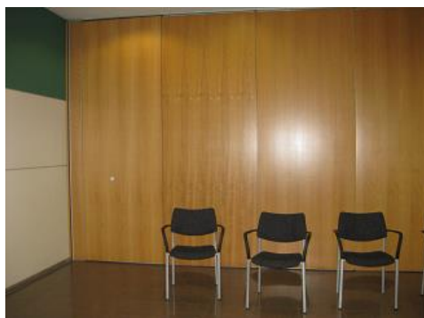
Foto 1. Paneles móviles de compartimentación en salas 3.13 y 3.14 (A,B,C).
