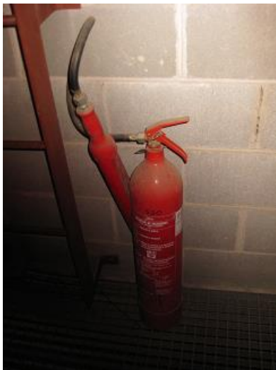
Foto 1. Extintores sin colgar y sin mantenimiento.
