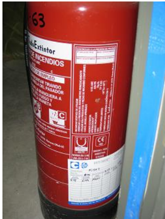
Foto 3. Extintores sin revisar en la zona de almacenes Comsa.
