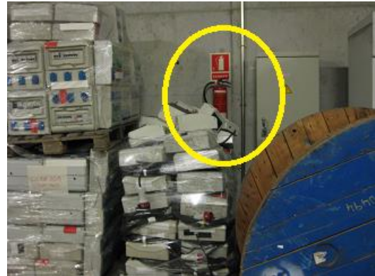
Foto 2. Extintores y BIE obstaculizados detrás de la desenrolladora de cable.
