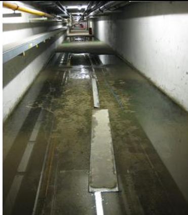
Foto 5. Acumulación de agua en galerías de paso (lado p. 4).
