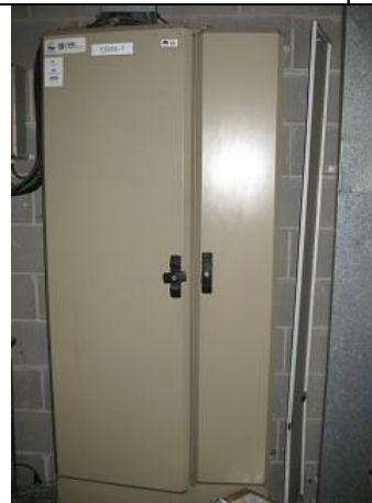
Foto 4. Cuadros eléctricos sin señalización.
