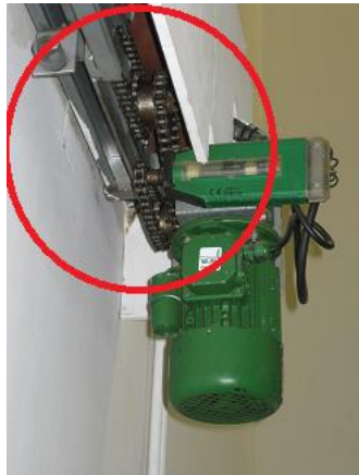
Foto 1. Motor y engranajes maquinaria de puerta entrada rambla 3-4 desprotegido
