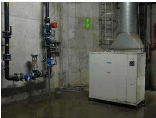
Foto 3. Equipos con conexiones eléctricas en zonas con acumulación de agua.
