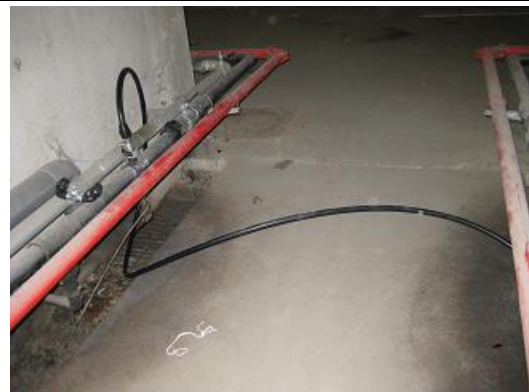
Foto 2. Conductos de agua cruzando la galería transversal 3.5 a media altura.
