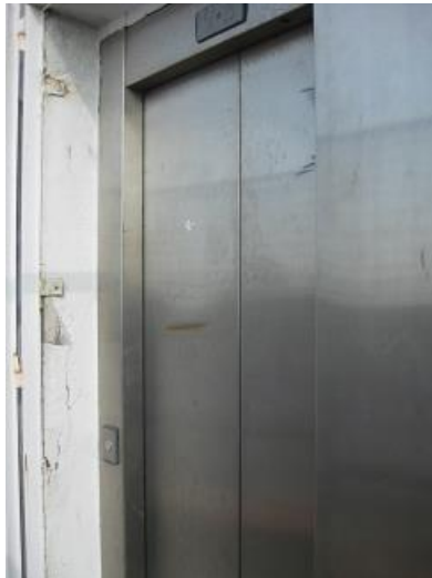
Foto 1. Ascensor sin señalizar la prohibición de uso en caso de emergencia.
