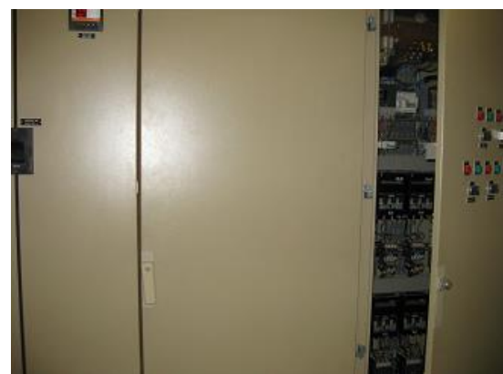
Foto 2. Cuadros eléctricos de transformación de baja tensión abiertos en varias salas.
