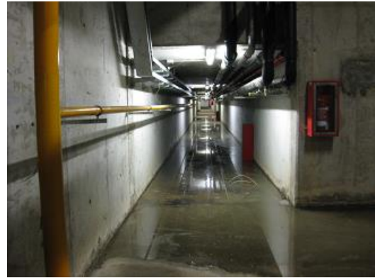
Foto 6. Acumulación de agua en galerías de paso (lado P.5)
