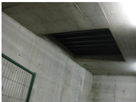
Foto 1. Trampilla del almacén de bobinas para entrada de equipos y materiales de altura superior a 2 m.
