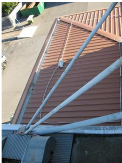
Foto 3. En mantenimiento de luminarias en cubiertas laterales sin protección perimetral.
