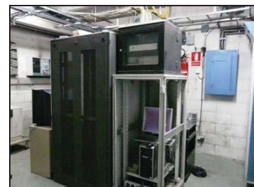
Sala de comunicacions
