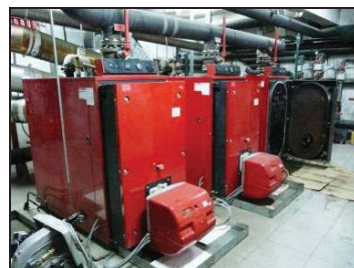
Sala de calderes
