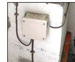
Connexió a terra
