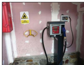
Càrrega de combustible per vehicles
