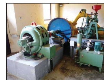
Sala de bombes
