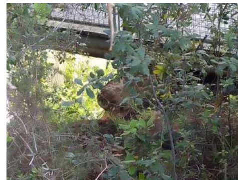
Aflorament de la fonamentació de l'estrep de la passera per efecte de l'erosió i dels desprendiments del front del talús.
