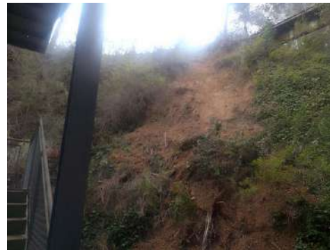
Vista actual del talús, on es pot observar l'efecte de l'erosió sobre el vessant; en segon terme, a dalt s'hi observa la passera de vianants
