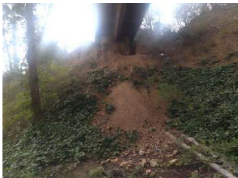
Vista actual de la capçalera del talús i del taulell de la passera per sota, on es pot observar l'efecte de l'erosió sobre el vessant
