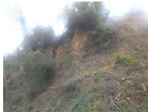
Vista actual de la capçalera del talús, on es pot observar l'efecte de l'erosió sobre el vessant
