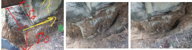
Estat actual de la fonamentació (fotografies rebudes de COTCA).
