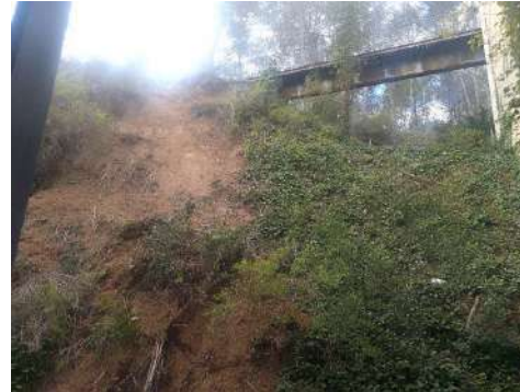
Vista actual del talús, on es pot observar l'efecte de l'erosió sobre el vessant; en segon terme, a dalt s'hi observa la passera de vianants
