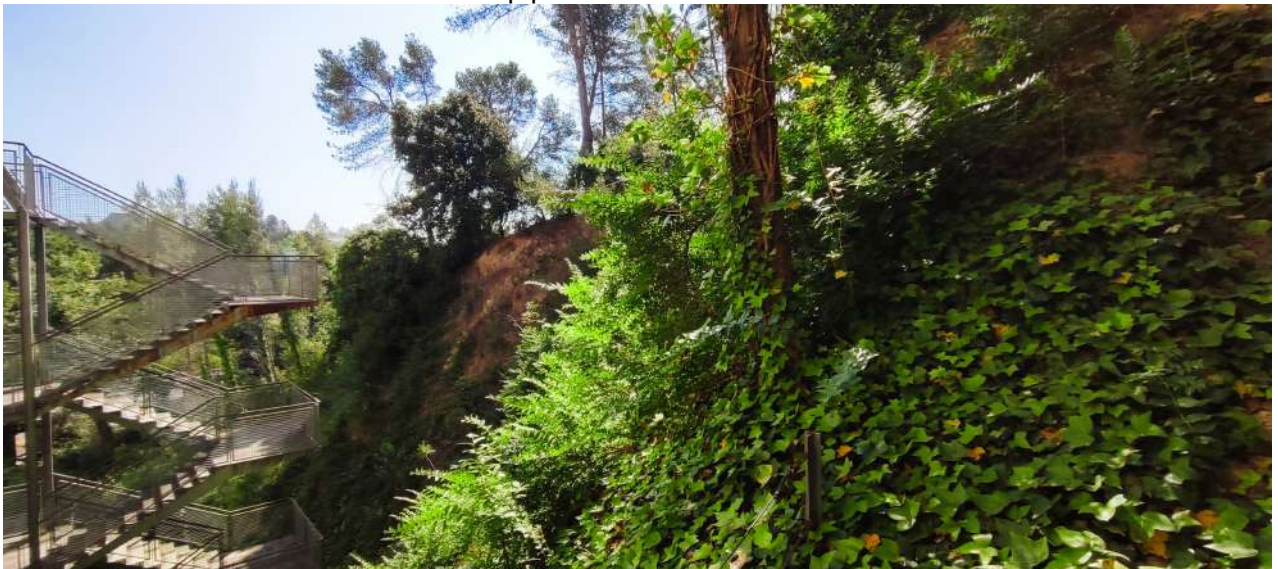
FOTO 4. Vista capçalera de talús des de el peu de la passera. Data 10/11/2025.
