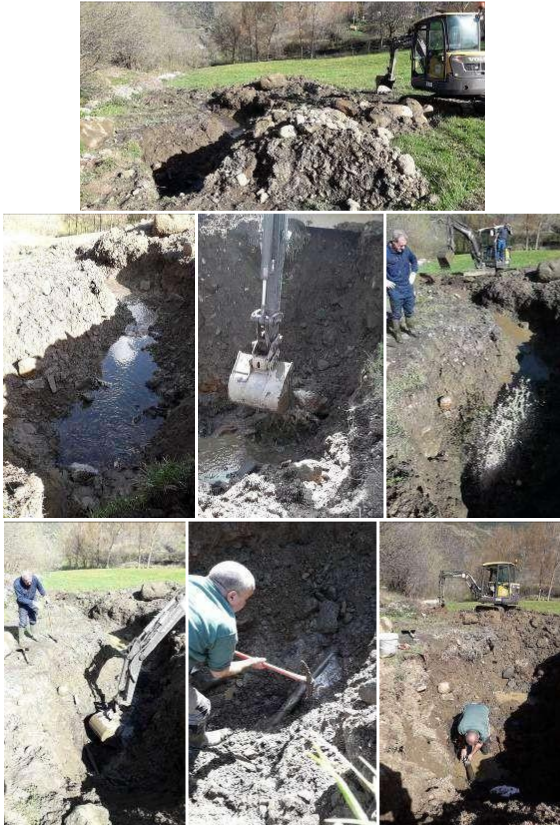
Figura 3. Fuita reparada el 29/4/22
