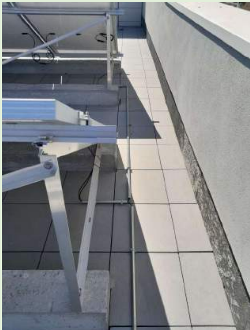
Canalitzacions instal·lades de forma incorrecta en zona de pas fàcil d'ensopegar, sense accessoris per fer els empalmes i sense connectar a terra. S'ha d'aprofitar el terra tècnic en aquest cas.
