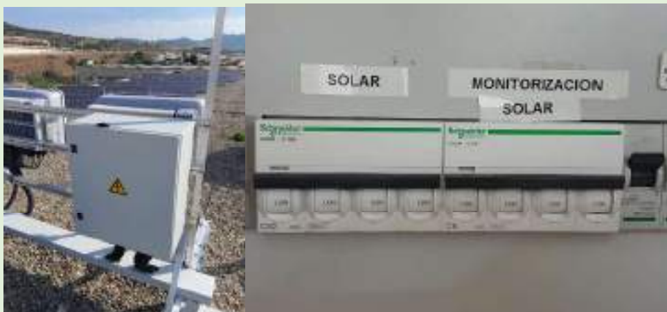
Exemple de quadre i proteccions senyalitzades.
