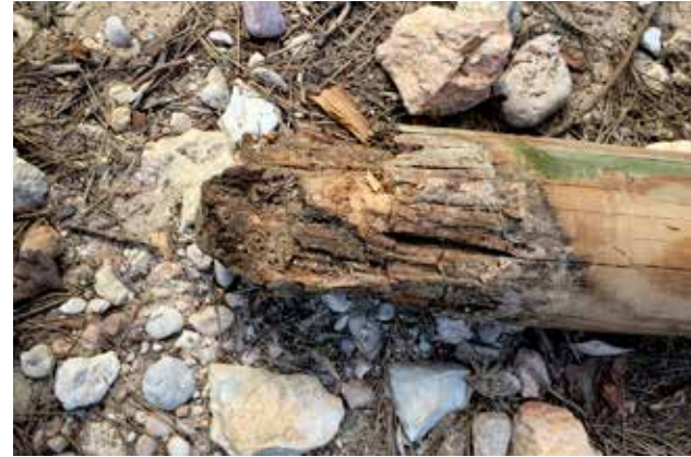
Suport de fusta podrit degut a un tractament deficient
