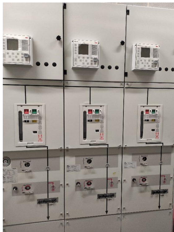
Fotografia 4 Celdas de MT
