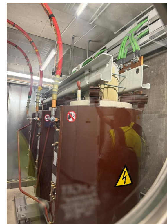
Fotografia 3 Interior del CT Existent
