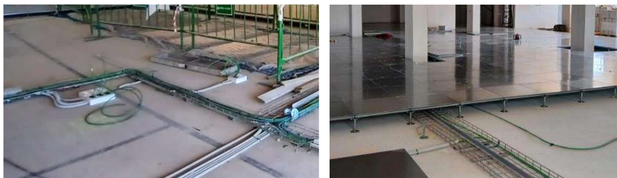
Fotografies del terra tècnic de la Biblioteca
