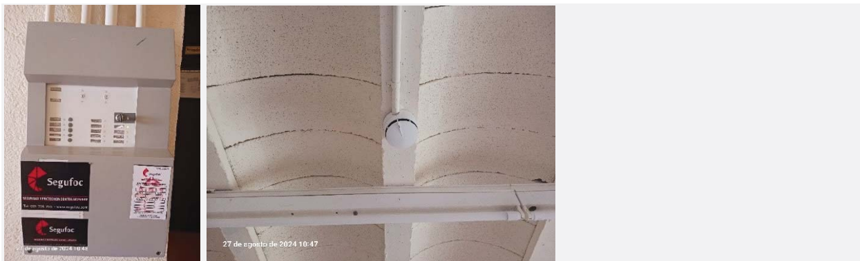
Figura 17: Fotografies instal·lació de seguretat i vigilància Font: Pròpia
