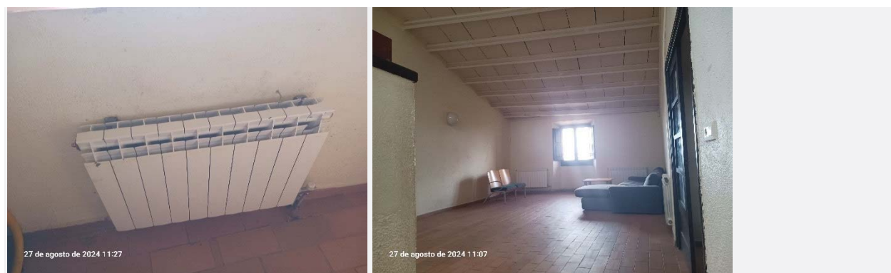
Figura 14: Fotografies instal·lació climatització Font: Pròpia
