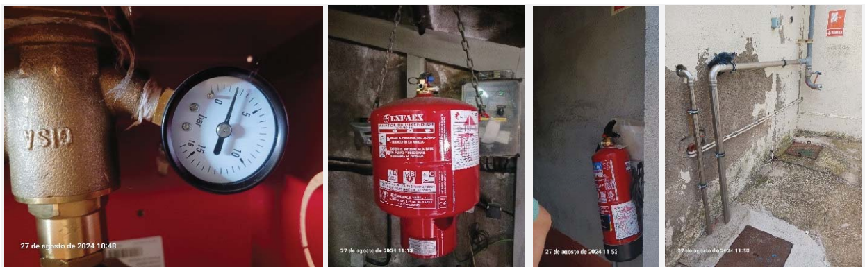
Figura 15: Fotografies instal·lació PCI Font: Pròpia
