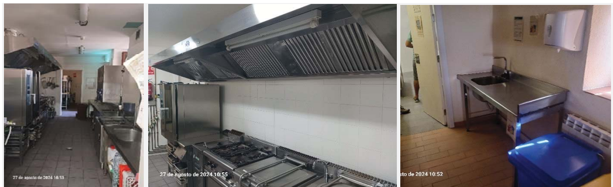
Figura 18: Fotografies instal·lació cuina industrial Font: Pròpia
