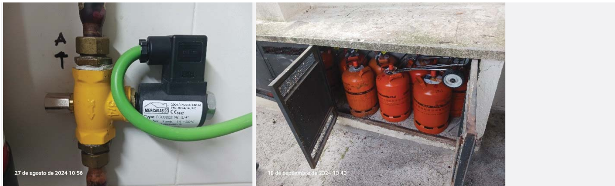
Figura 16: Fotografies instal·lació Gas Font: Pròpia
