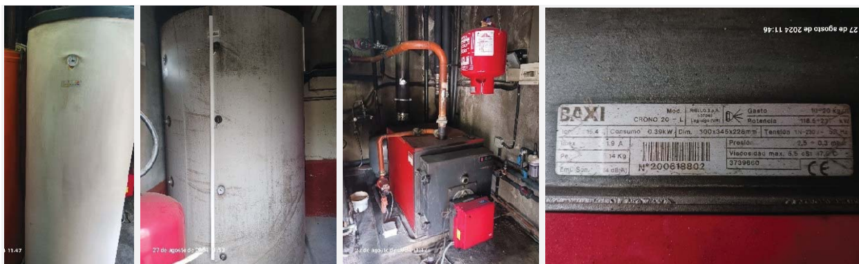
Figura 11: Fotografies instal·lació ACS Font: Pròpia
