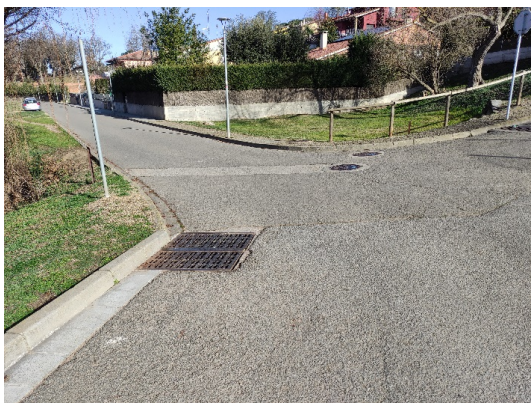
Figura 2 Confluència de carrers, amb embornals de recollida d'aigua de pluja i registres de la xarxa de pluvials.
