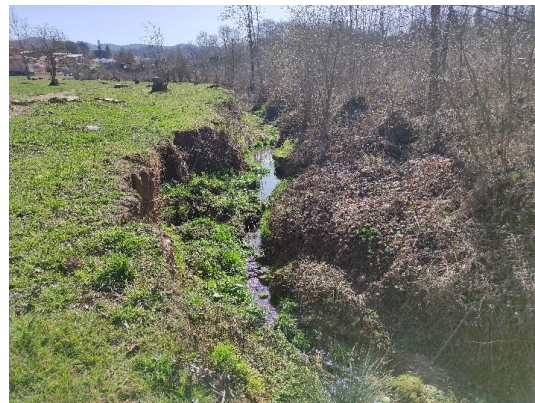
Figura 11 Riera i marge dret (esquerra a la fotografia) verticalitzat
