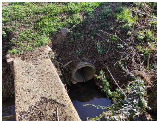
Figura 3 Tub d'abocament de pluvials i passera per creuar la riera
