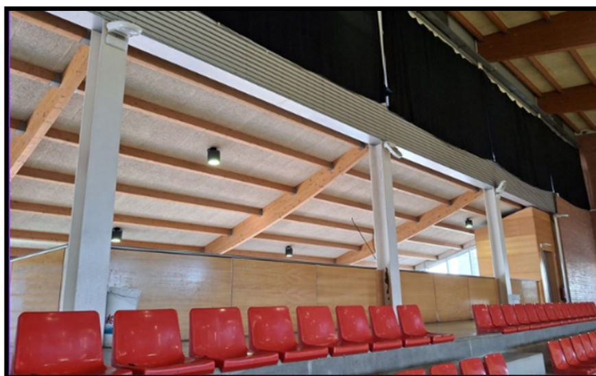
Fotografia de la ubicació de la xarxa des del primer pis dins la instal·lació.
