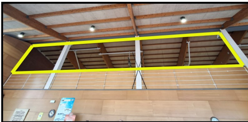
Fotografia de la ubicació de la xarxa des de la planta baixa (en groc) dins la instal·lació.
