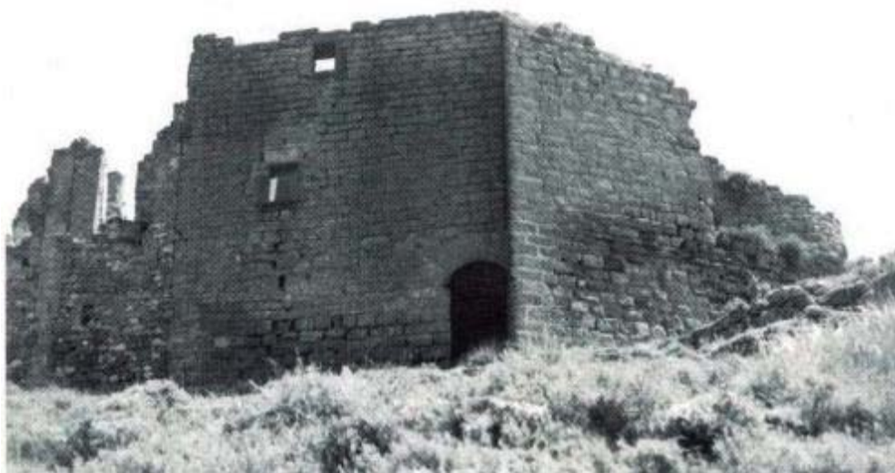
Fotografia 1. Façana de ponent del cos 18 del castell. Extreta de Català, 1979:25. La finestra superior avui ja no hi és, i amb ella van caure prop de 7 filades d'aquest mur. precisament en aquest vessant es troben un gran nombre de carreus caiguts.
