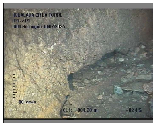
Foto: 2_1_3_16072025_102407102407_B.JPG 3,6m, COLECTOR SIN SUELO (PUNTUAL)
