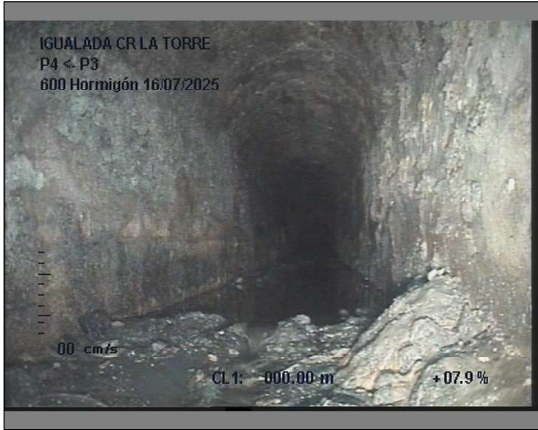
Foto: 5_1_4_16072025_112316112316_A.JPG 0m, INTERRUPCION POR SUCIEDAD , DE PIEDRAS Y TOCHOS
