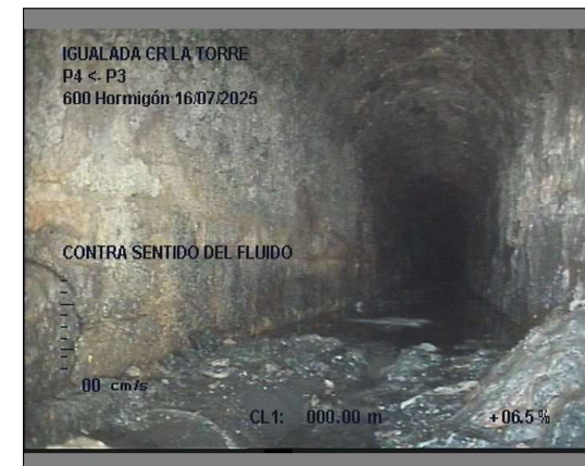
Foto: 5_1_2_16072025_111940111940_A.JPG 0m, CONTRA SENTIDO DEL FLUIDO
