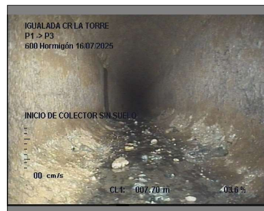
Foto: 2_1_4_16072025_102505102505_A.JPG 7,7m, INICIO DE COLECTOR SIN SUELO
