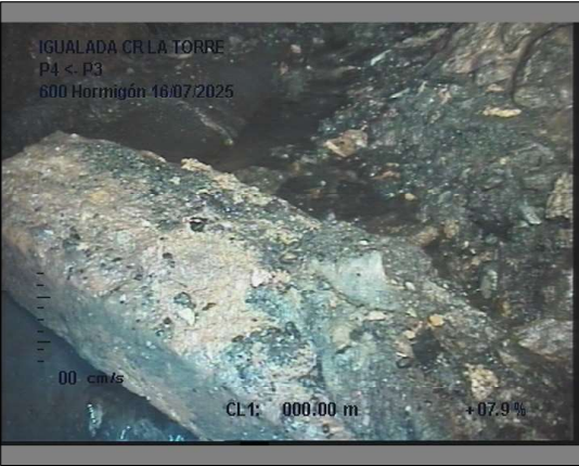
Foto: 5_1_4_16072025_112323112323_B.JPG 0m, INTERRUPCION POR SUCIEDAD , DE PIEDRAS Y TOCHOS
