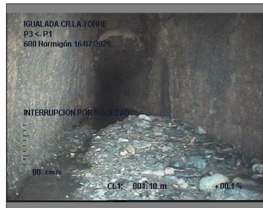
Foto: 4_1_5_16072025_110729110729_A.JPG 4,1m, INTERRUPCION POR SUCIEDAD
