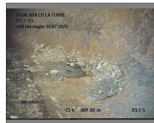
Foto: 2_1_5_16072025_102558102558_B.JPG 9,8m, COLECTOR SIN SUELO (PUNTUAL)
