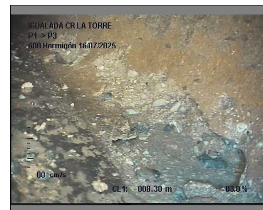
Foto: 2_1_4_16072025_102521102521_B.JPG 7,7m, INICIO DE COLECTOR SIN SUELO
