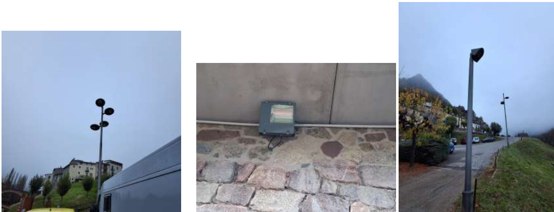
Imatge 7. Esquerra: Projectors per a il·luminació general de l'aparcament. Centre: projector sota volaviu a substituir. Dreta: fanal de vapor de sodi a substituir.
