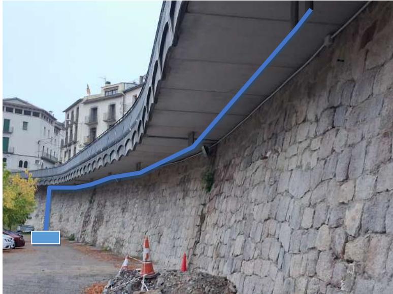
Imatge 8. Ramal de col·lecció de l'aigua pluvial per a reutilització.
