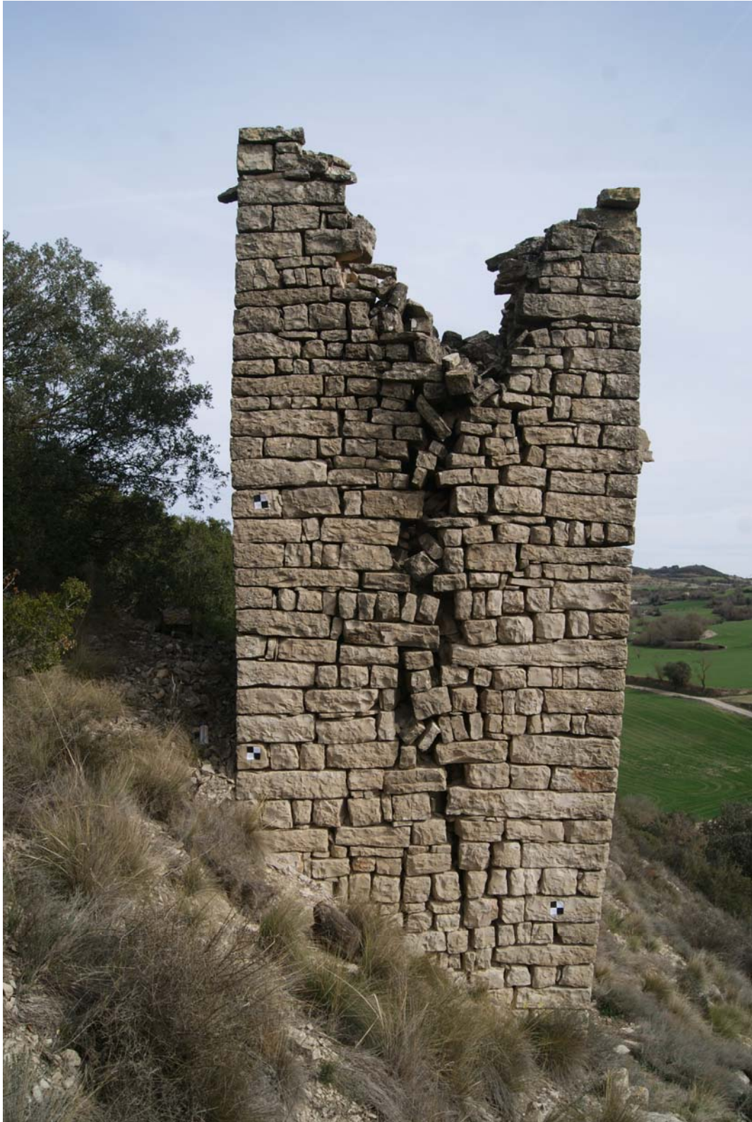
Vista de la façana oest amb una esquerdada vertical més oberta encara que la de la façana est
