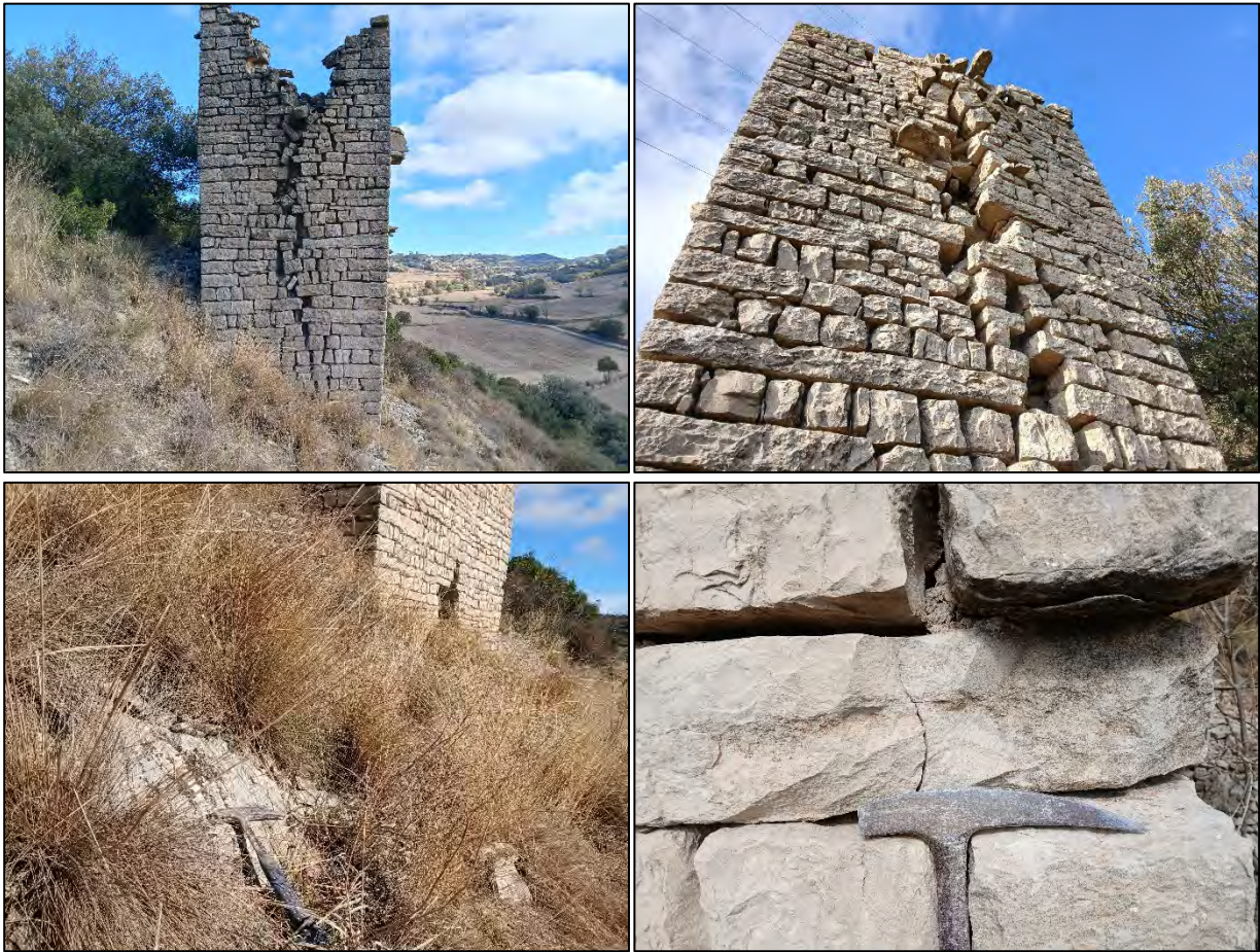
Figura 2. Fotografies de l'estat actual del "Colomar de Gospí".
