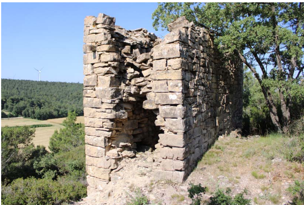
Colomer de Conesa: vista de la façana est, parcialment enderrocada
