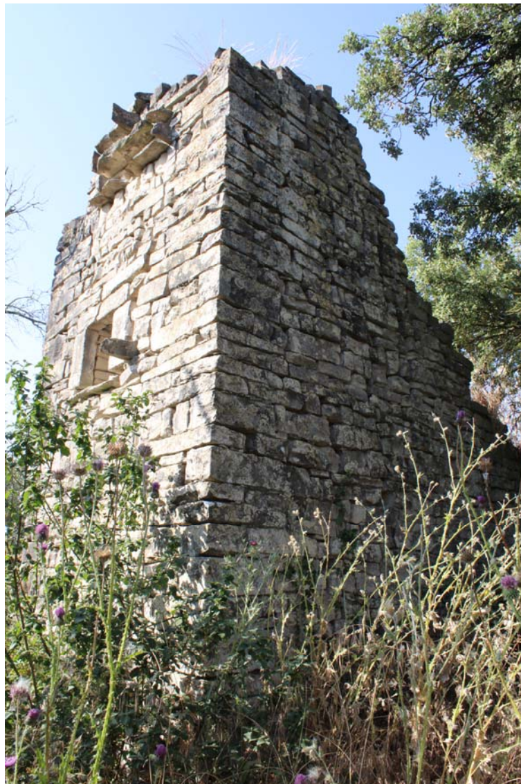
Colomer de Pallerols: vista de les façanes est i nord. La façana est presenta una esquerda longitudinal, encara no massa evolucionada.
