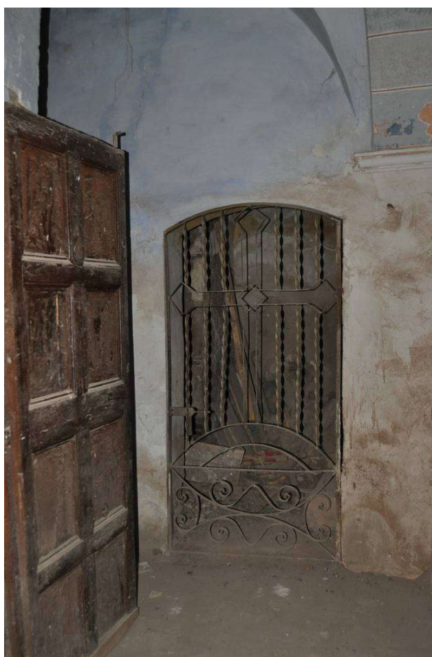
Restes de pintures en sostre de capella parcialment tapiada i reixa a recuperar, d'accés a la capella . Zona façana nord lateral esquerra
