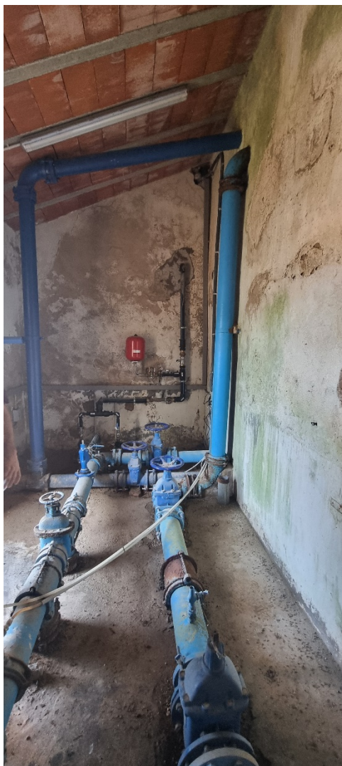
Imatge de la caseta on es renovaran totes les canonades
