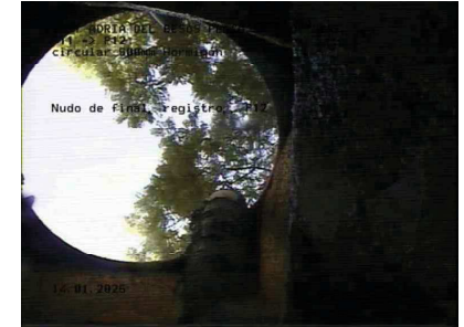
27-SANT ADRIÀ DEL BESÒS-PLAÇA 25 D'OCTUBREP11P12.jpg, 00:08:51, 16.44m Nudo de final, registro, P12
