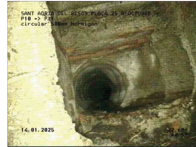
39-SANT ADRIÀ DEL BESÒS-PLAÇA 25 D'OCTUBRE P10P11.jpg, 00:09:20, 22.60m Nudo de final, registro., P11
