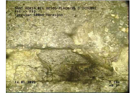
20-SANT ADRIÀ DEL BESÒS-PLAÇA 25 D'OCTUBRE P11P12.jpg, 00:03:14, 7.18m Junta desplazada, longitudinal,, 20mm desde 12 Reloj a 12 Reloj
