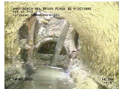
28-SANT ADRIÀ DEL BESÒS-PLAÇA 25 D'OCTUBREP11P12.jpg, 00:08:51, 16.44m Nudo de final, registro, P12
