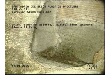
32-SANT ADRIÀ DEL BESÒS-PLAÇA 25 D'OCTUBRE P10P11.jpg,00:07:14,17.34m Unión, conexión abierta., altura: 81mm, anchura: 81mm a 11 Reloj
