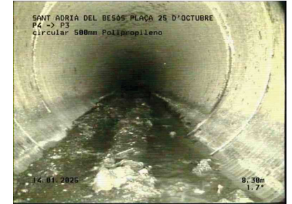
45-SANT ADRIÀ DEL BESÒS-PLAÇA 25 D'OCTUBREP3P4.jpg, 00:01:53, 7.80m Depósitos áridos gruesos (por ejemplo cascotes, gravar) en el hilo, grueso, 20%
