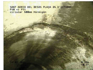
25-SANT ADRIÀ DEL BESÒS-PLAÇA 25 D'OCTUBRE D'OCTUBRE10P11.jpg, 00:03:30, 8.22m Junta desplazada, longitudinal., 50mm desde 12 Reloj a 12 Reloj
