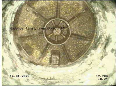
48-SANT ADRIÀ DEL BESÒS-PLAÇA 25 D'OCTUBREP3P4.jpg, 00:03:44, 19.90m Nudo de final, registro., P3
