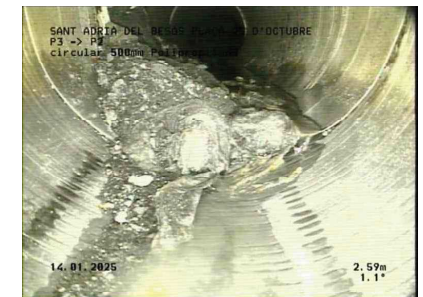
53-SANT ADRIÀ DEL BESÒS-PLAÇA 25 D'OCTUBRE P3P2.jpg, 00:00:49, 2.59m Inspección abandonada, obstrucción
