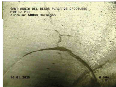
23-SANT ADRIÀ DEL BESÒS-PLAÇA 25 D'OCTUBRE D'OCTUBRE10P11.jpg, 00:02:09, 0.36m Fisura, grieta superficial, longitudinal, anchura de la fisura, 2mm a 3 Reloj
