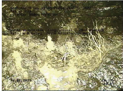
23-SANT ADRIÀ DEL BESÒS-PLAÇA 25 D'OCTUBREP11P12.jpg, 00:05:43, 10.19m Junta desplazada, longitudinal, 20mm desde 4 Reloj a 8 Reloj / JUNTA ABIERTA CON RAIZES
