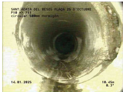
29-SANT ADRIÀ DEL BESÒS-PLAÇA 25 D'OCTUBRE P10P11.jpg,00:05:16,10.45m Unión, conexión abierta., altura: 81mm, anchura: 81mm a 3 Reloj
