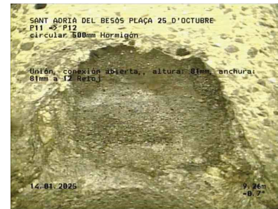
21-SANT ADRIÀ DEL BESÒS-PLAÇA 25 D'OCTUBRE P11P12.jpg, 00:05:05, 9.26m Unión, conexión abierta,, altura: 81mm, anchura: 81mm a 12 Reloj
