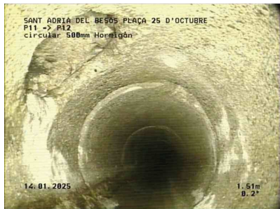
17-SANT ADRIÀ DEL BESÒS-PLAÇA 25 D'OCTUBRE P11P12.jpg, 00:00:55, 1.51m Unión, conexión abierta,, altura: 81mm, anchura: 81mm a 10 Reloj
