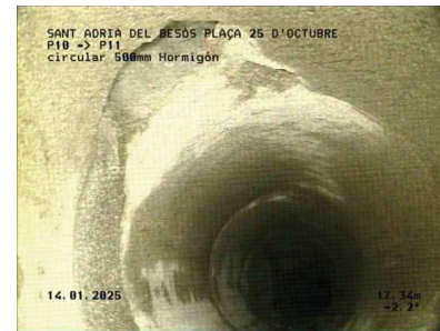
33-SANT ADRIÀ DEL BESÒS-PLAÇA 25 D'OCTUBRE P10P11.jpg,00:07:14,17.34m Unión, conexión abierta., altura: 81mm, anchura: 81mm a 11 Reloj
