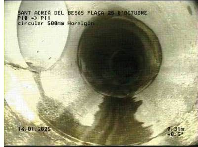
26-SANT ADRIÀ DEL BESÒS-PLAÇA 25 D'OCTUBRE P10P11.jpg,00:04:09,9.31m Unión, conexión abierta., altura: 81mm, anchura: 81mm a 9 Reloj
