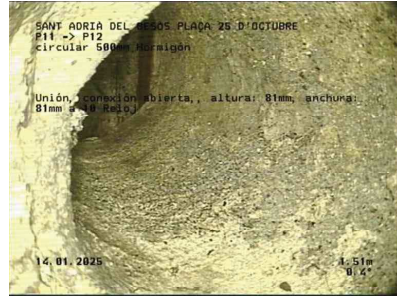
16-SANT ADRIÀ DEL BESÒS-PLAÇA 25 D'OCTUBRE P11P12.jpg, 00:00:55, 1.51m Unión, conexión abierta,, altura: 81mm, anchura: 81mm a 10 Reloj
