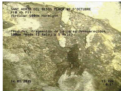
30-SANT ADRIÀ DEL BESÒS-PLAÇA 25 D'OCTUBRE P10P11.jpg,00:06:17,13.22m Pérdidas, fragmentos de la pared desaparecidos., 500mm desde 12 Reloj a 5 Reloj
