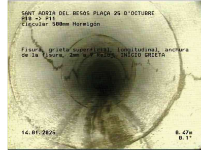
22-SANT ADRIÀ DEL BESÒS-PLAÇA 25 D'OCTUBRE D'OCTUBRE10P11.jpg, 00:02:22, 0.47m Fisura, grieta superficial, longitudinal, anchura de la fisura, 2mm a 9 Reloj / INICIO GRIETA
