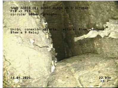
36-SANT ADRIÀ DEL BESÒS-PLAÇA 25 D'OCTUBRE P10P11.jpg, 00:08:37, 22.03m Unión, conexión abierta., altura: 81mm, anchura: 81mm a 9 Reloj
