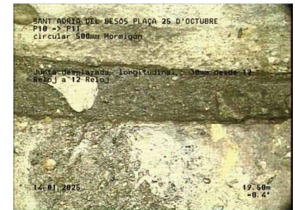
34-SANT ADRIÀ DEL BESÒS-PLAÇA 25 D'OCTUBRE P10P11.jpg,00:07:47,19.50m Junta desplazada, longitudinal., 30mm desde 12 Reloj a 12 Reloj
