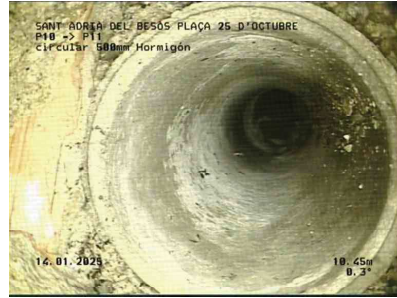
28-SANT ADRIÀ DEL BESÒS-PLAÇA 25 D'OCTUBRE P10P11.jpg,00:05:16,10.45m Unión, conexión abierta., altura: 81mm, anchura: 81mm a 3 Reloj
