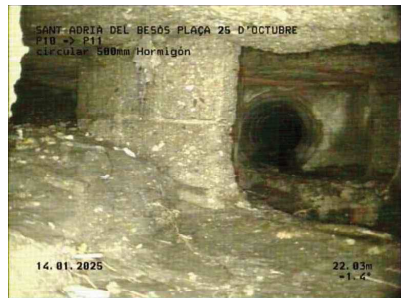
37-SANT ADRIÀ DEL BESÒS-PLAÇA 25 D'OCTUBRE P10P11.jpg, 00:08:37, 22.03m Unión, conexión abierta., altura: 81mm, anchura: 81mm a 9 Reloj
