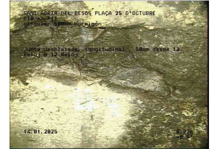
24-SANT ADRIÀ DEL BESÒS-PLAÇA 25 D'OCTUBRE D'OCTUBRE10P11.jpg, 00:03:30, 8.22m Junta desplazada, longitudinal., 50mm desde 12 Reloj a 12 Reloj
