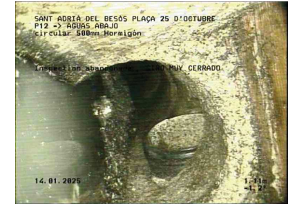
31-SANT ADRIÀ DEL BESÒS-PLAÇA 25 D'OCTUBRE P12AGUAS ABAJO.jpg, 00:01:09, 1.11m Inspeccion abandonada,, GIRO MUY CERRADO
