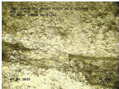
26-SANT ADRIÀ DEL BESÒS-PLAÇA 25 D'OCTUBREP11P12.jpg, 00:07:27, 15.47m Junta desplazada, longitudinal, 30mm desde 12 Reloj a 12 Reloj
