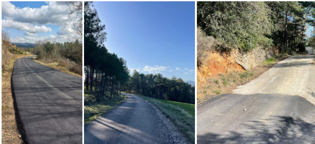
Figures 21, 22 i 23: Imatges de l'estat actual de les cunetes.
