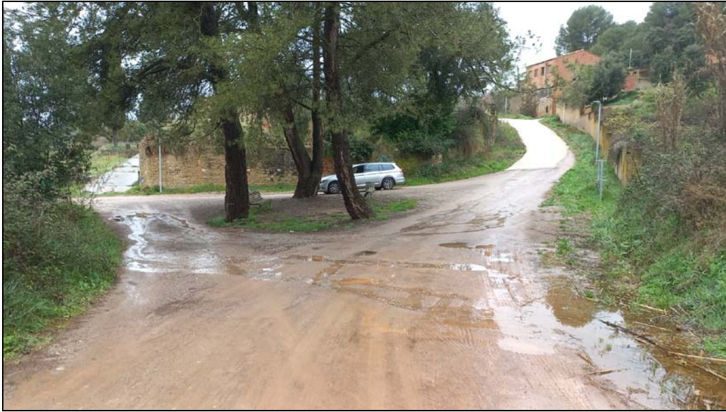
Imatge 6. Àmbit a pavimentar. A l'esquerra de la imatge, punt on es realitzarà obra de drenatge DN600 per a la recollida d'aigües de la cuneta.
