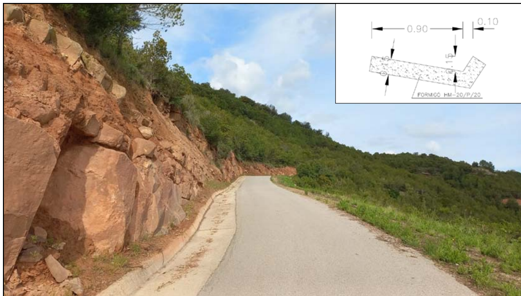
Imatge 4. Exemple de camí amb cuneta transitable i paviment asfàltic. Esquema de cuneta.
