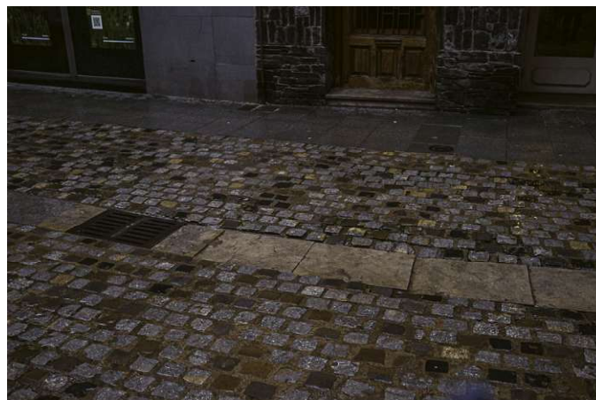
Pavimentació en mal estat a reparar
