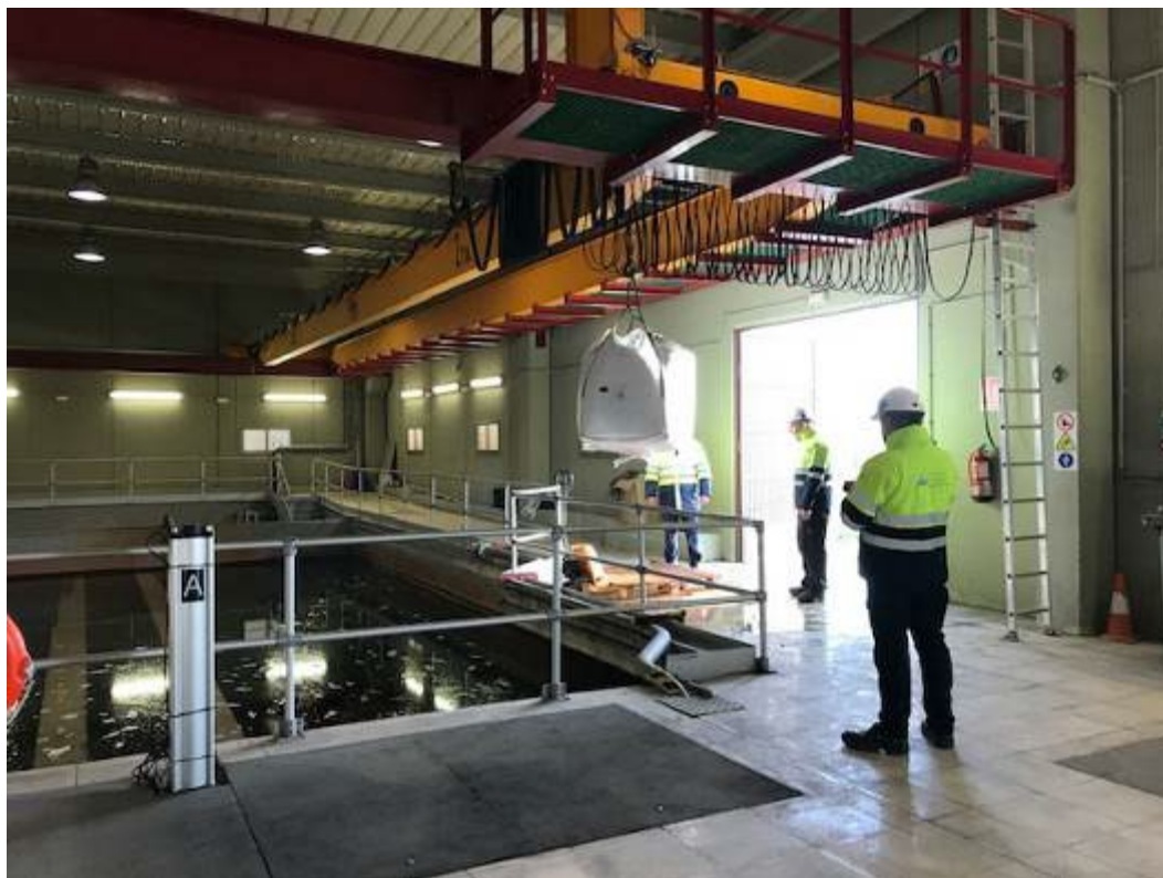
Zona interior, descàrrega a filtre
