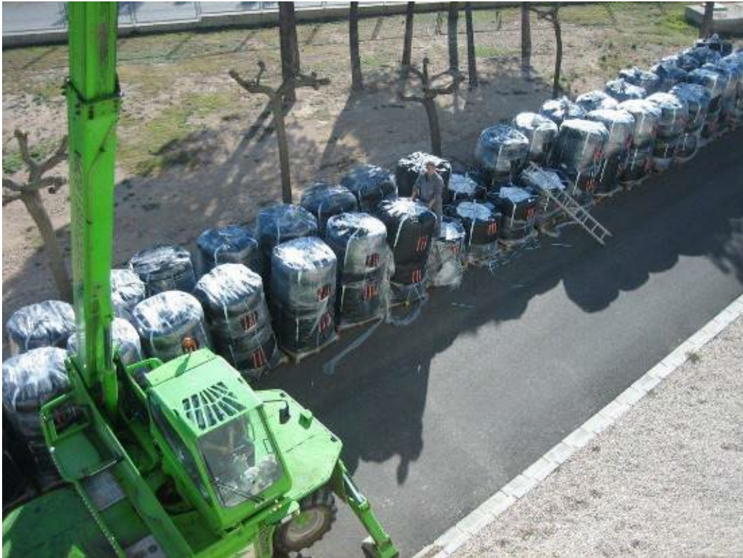
Zona exterior amb els manipuladors
