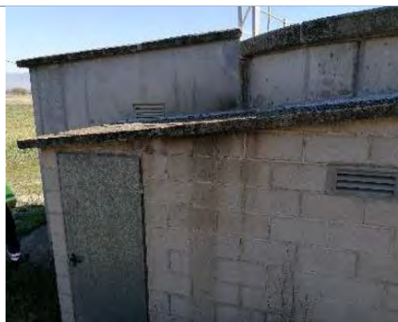
Figura 12: Caseta de dispensador de Clor Cap del Pla
