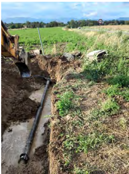
Figura 6: Tram d'avaría canonada tram Sud
