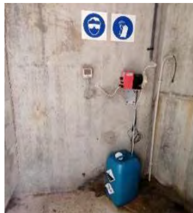
Figura 15: Clor del dipòsit de Vespella
