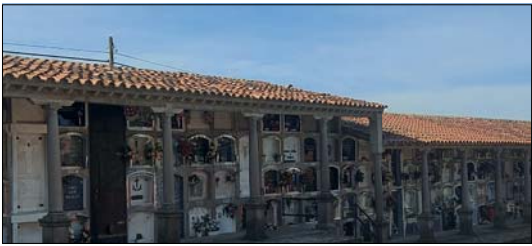
COBERTES AMB MAL ESTAT, REPARACIÓ GENERAL DE COBERTES
