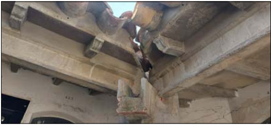
AIGUAFONS EXISTENT AMB MAL ESTAT
