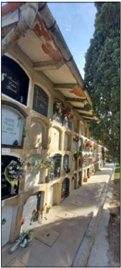
DETERIORAMENT DEL REVESTIMENT SOTA PORXO
