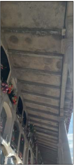
DETERIORAMENT DEL REVESTIMENT SOTA PORXO
