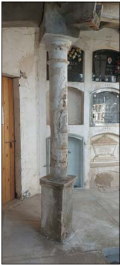
PILAR AMB DETERIORAMENT DEL REVESTIMENT
