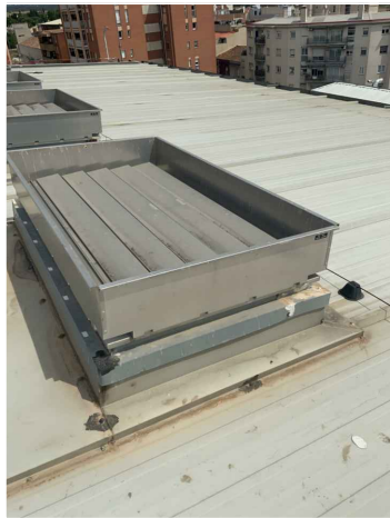
IMG 08. Exutori coberta sandwich amb filtracions d'aigua
