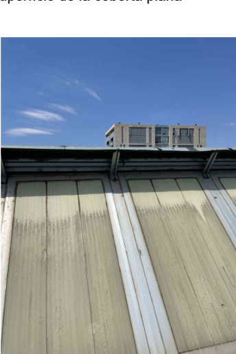
IMG 05. Visera protecció superior de lluernari no funcional i juntes elements practicables degradades
