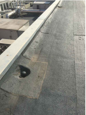
IMG 02. Impermeabilització bituminosa degradada i zona d'embornal
