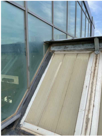
IMG 06. Trobada de lluernari amb mur de vidre amb filtracions d'aigua. Junta degradada
