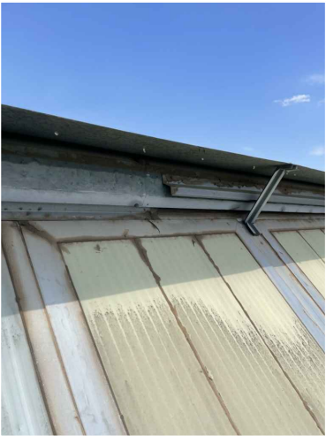
IMG 06. Junes elements practicables de lluernari degradades
