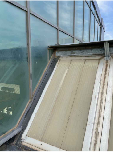
IMG 07. Trobada de lluernari amb mur de vidre amb filtracions d'aigua. Junta degradada
