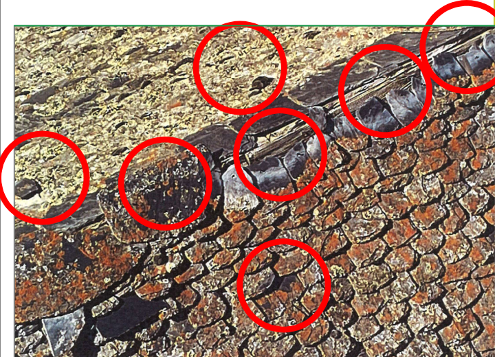
Coberta malmesa amb nombroses filtracions (foto 3)
