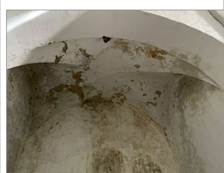
Importants danys provocats per l'existència de goteres a l'interior de l'església
