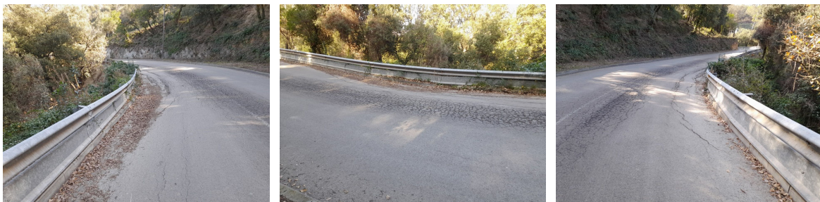
Imatges del tram afectat.
