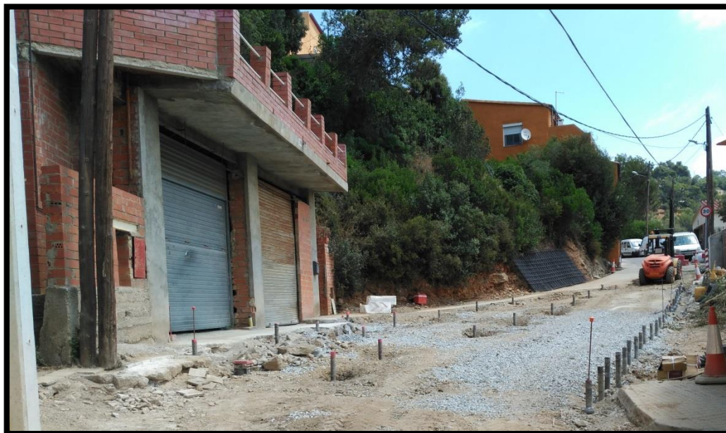
Pantalla de micropilotes y dos líneas adicionales de micropilotes que actúan a tracción.
