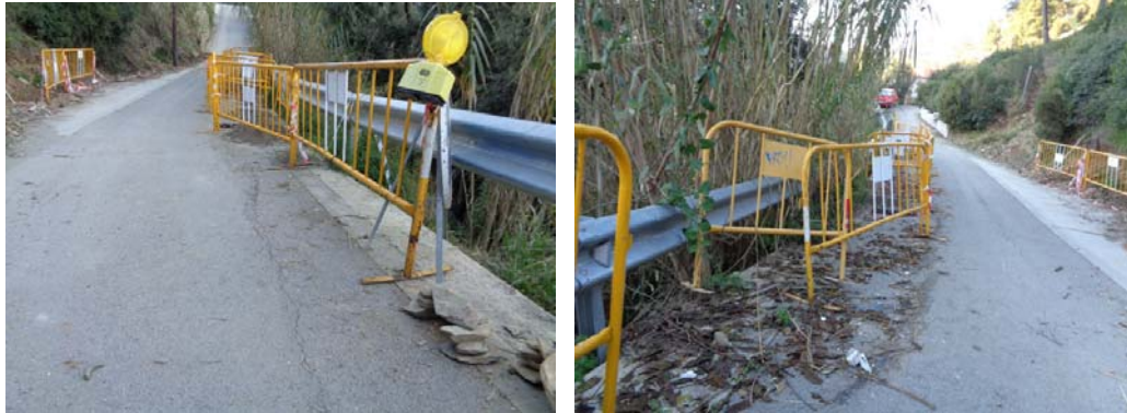
Esllavissada tram afectat
