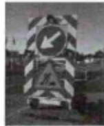
SEÑAL DE PELIGRO OBRA LUMINOSA
