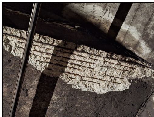
Detall de l'armadura vista
