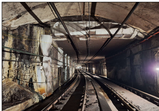
Vista de la junta afectada PK 102+470
