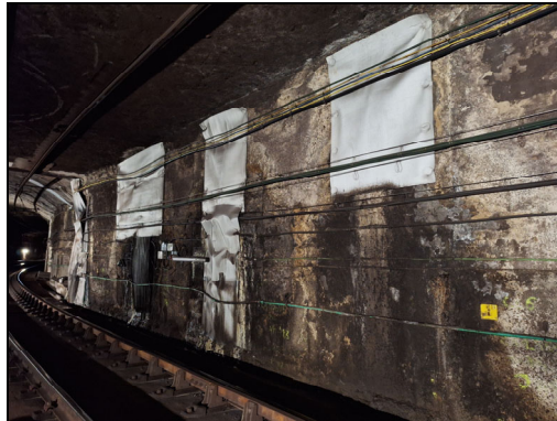
Filtracions juntes entre pantalles
