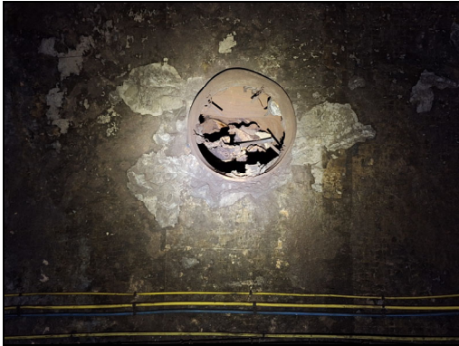
Vista del forat al PK 117+680
