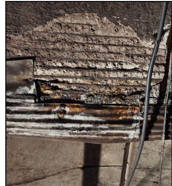
Armadures amb pèrdua de secció
