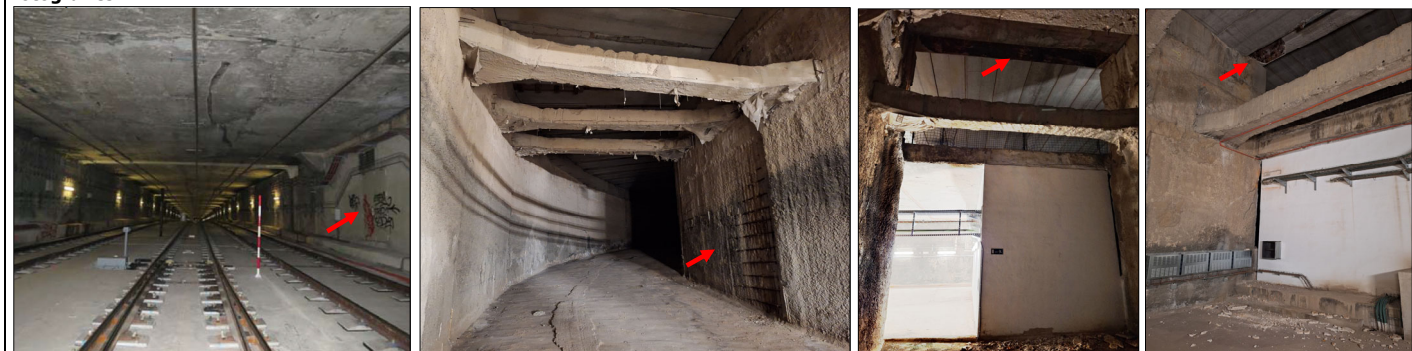
Vista accés pou PAF al túnel (PK 022+100-022+112) Vista de l'armadura vista a la rampa superior del pou PAF Vista dels desprendiments de l'ignifugat de la biga metàl·lica del llindà.
