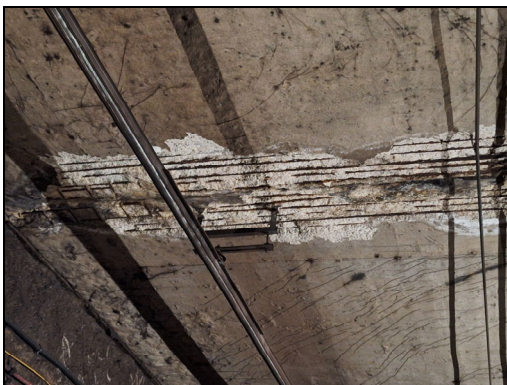
Estat actual de la junta sobre via 2
