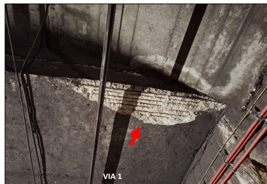
Detall de l'armadura vista
