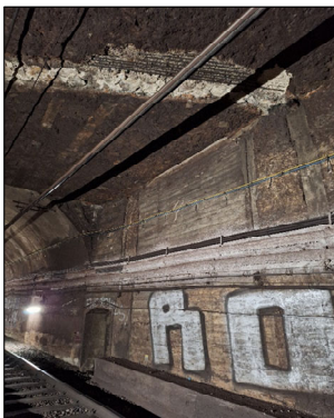
Despreniment sobre via 1
