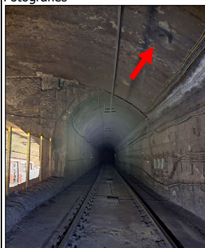
Vista de la secció afectada
