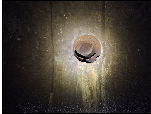
Vista del forat al PK 117+748
