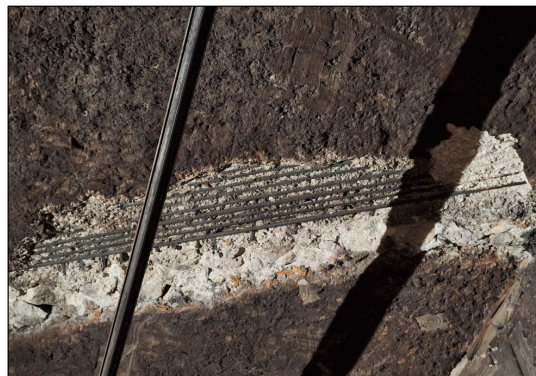
Detall de l'armadura vista resultant del despreniment
