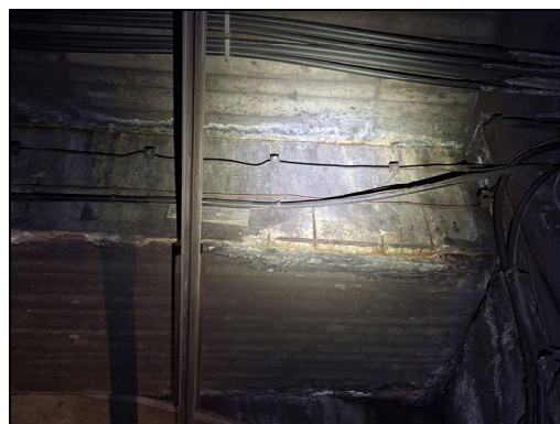
Detall de l'armadura vista
