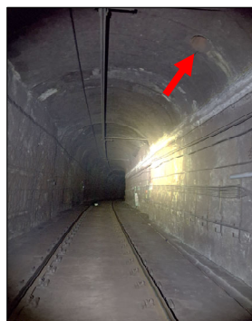
Vista de la secció afectada
