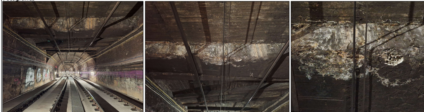
Vista de la secció de túnel afectada
