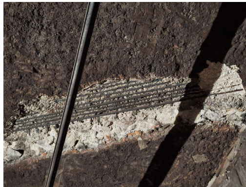
Detall de l'armadura vista
