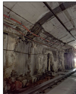
Filtració junta PK 102+400 via 2
