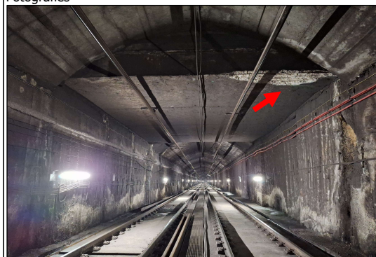
Vista de la secció afectada
