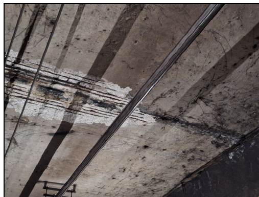
Estat actual de la junta sobre via 1
