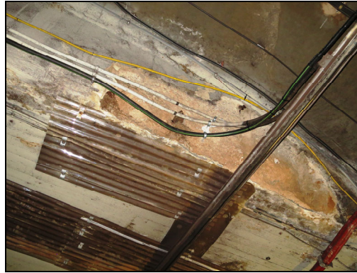
Detall dels desprendiments de la paret del pas
