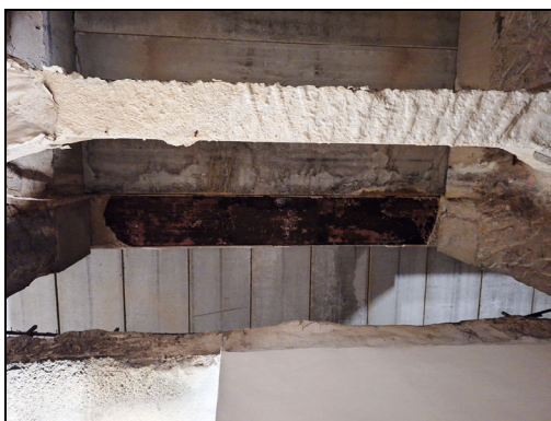
Detall de la biga metàl·lica sense protecció i oxidada
