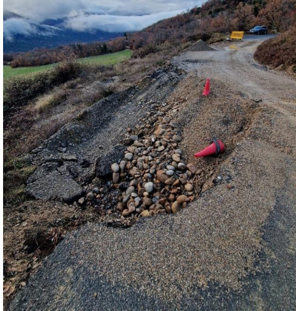
Il·lustració 4: Enfonsament del paviment
