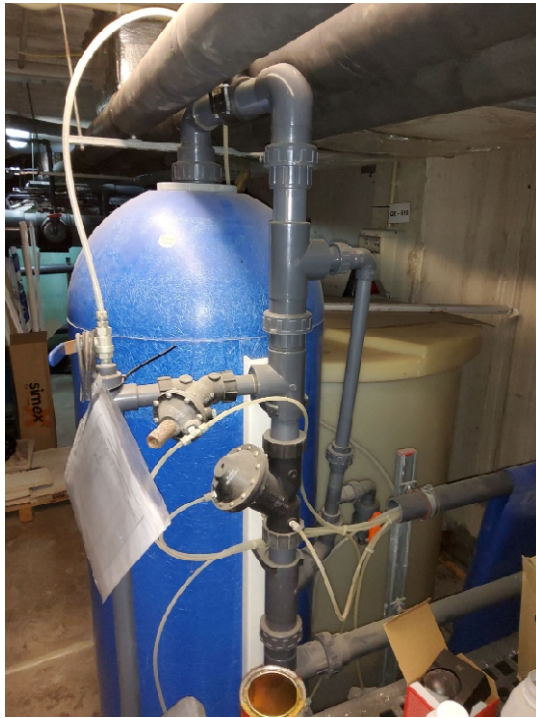
Foto 2. Descalcificador fora de servei
