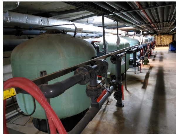
Foto 5. Filtres piscina gran (2 ut. en servei, 4 ut. Fora de servei)
