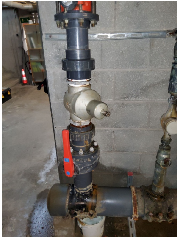
Foto 8. Vàlvula reguladora de pressió a substituir
