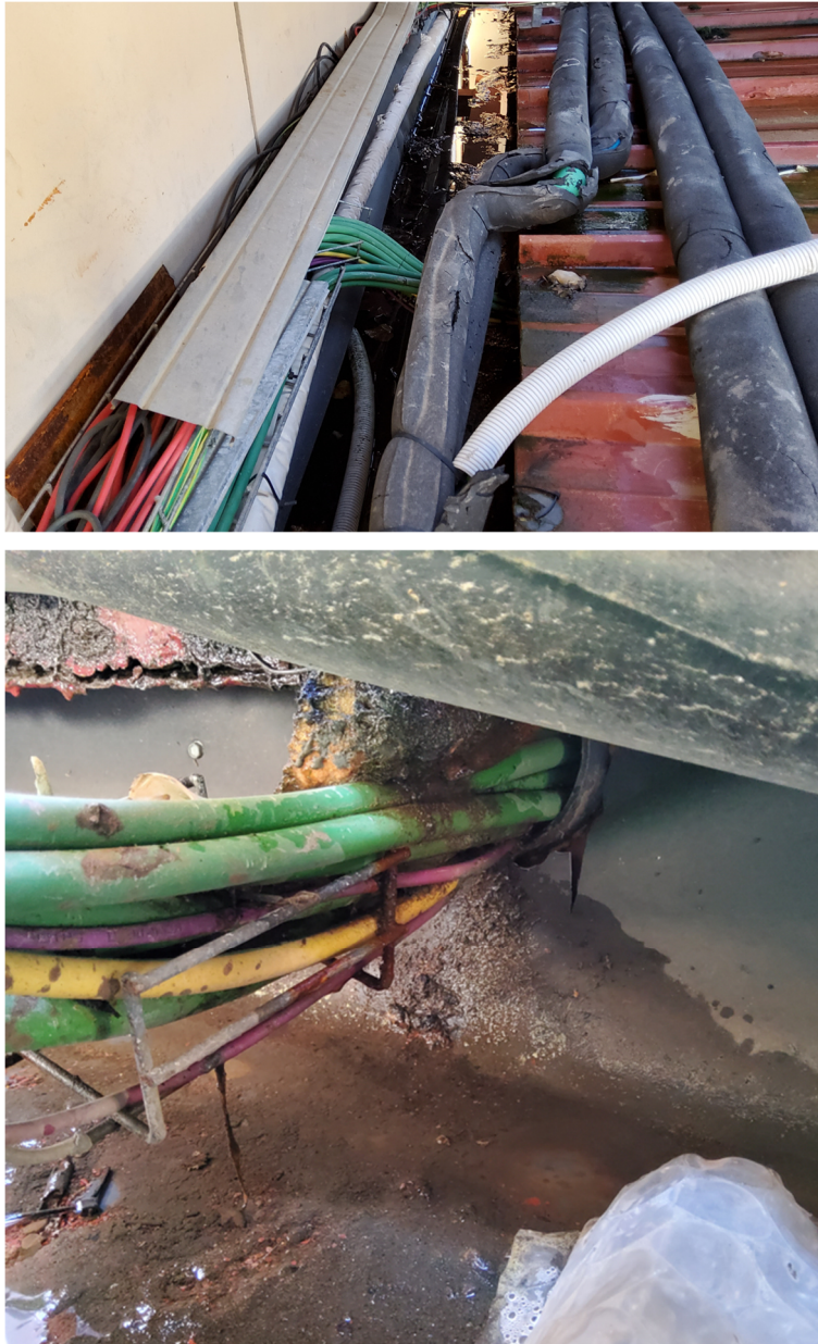
Fotos 9 i 10. Pas cablejat baixa tensió per canal de pluvials
