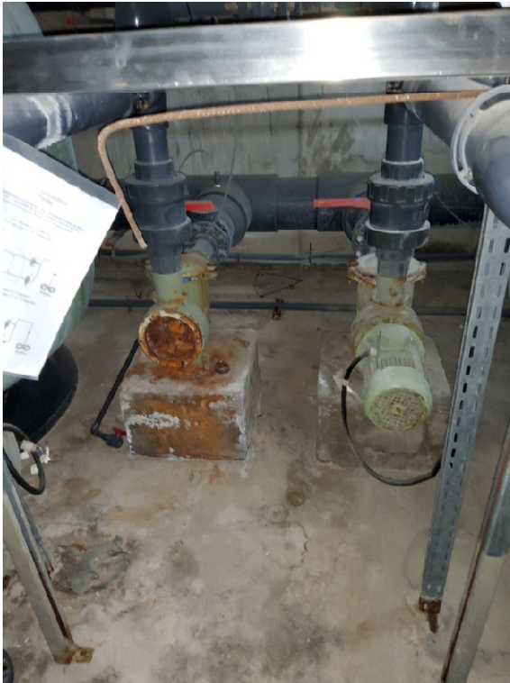
Foto 6. Bomba i prefiltrre piscina gran fora de servei
