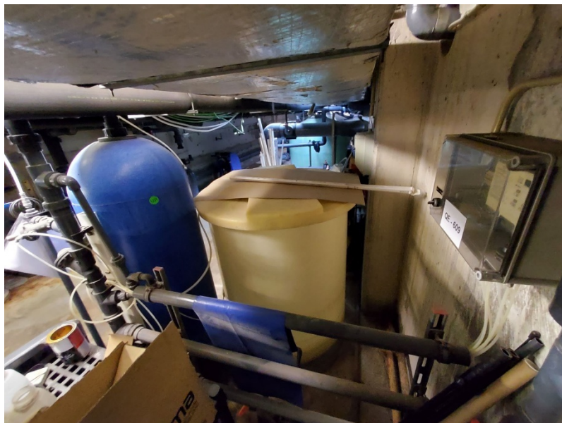
Foto 1. Descalcificador fora de servei
