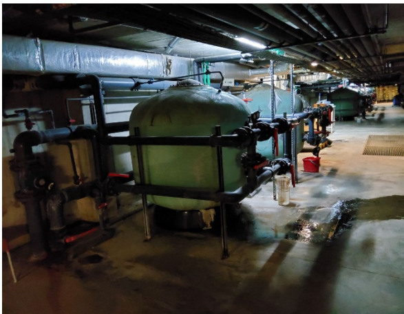
Foto 4. Filtres piscina petita (2 ut.)
