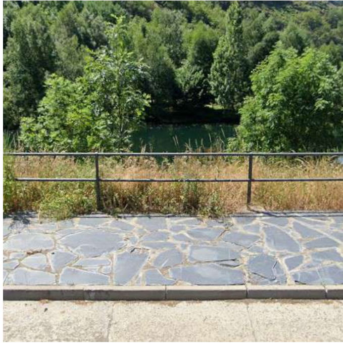
Imatge 8. Estat del paviment actual.
