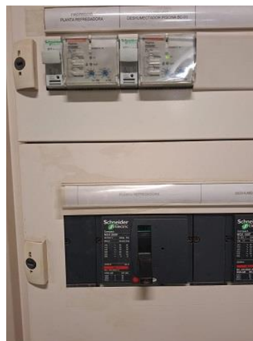
Fotografia 7.- Interruptor automàtic de caixa emmotllada i protecció diferencial regulable en quadre de comandament i protecció annex a la refredadora i a mantenir per alimentar la nova refredadora.
