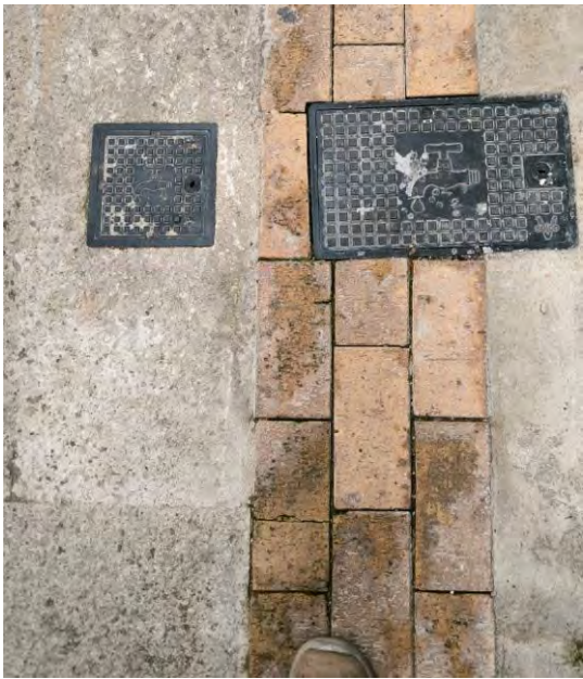
Comptador existent en arqueta al paviment
