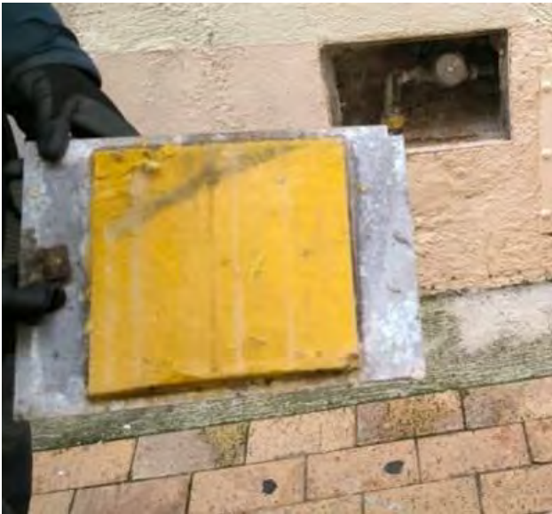
Portella existent en mal estat
