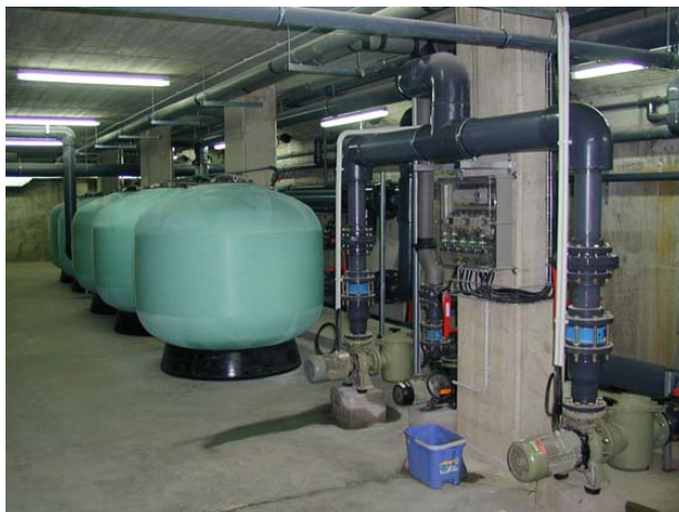
Equips de recirculació i filtració
