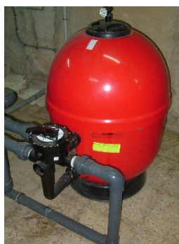
Manòmetre a capçalera d'un filtre
