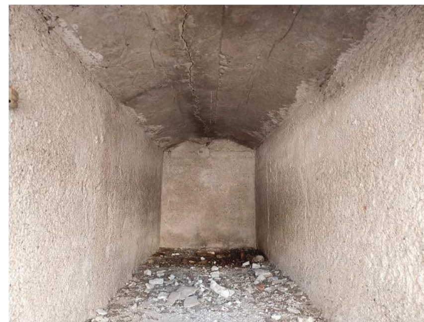
Nínxol 3690 Bloc 160 – Esquerra a la façana i a tota la longitud de la volta
