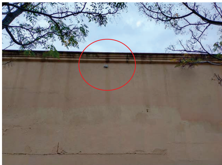
Clinòmetre CL037 al bloc 37
