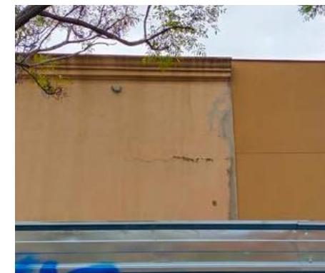
Clinòmetre CL037 al bloc 27
