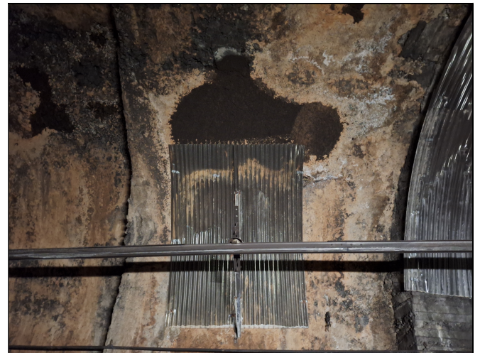
Foto 4: Detall de superfícies de formigó escrostonades
