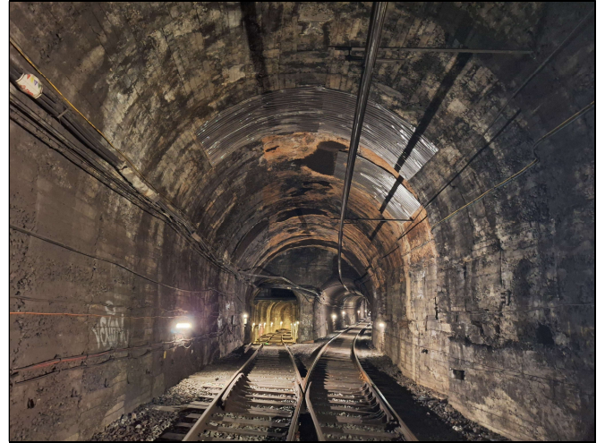
Foto 2: Vista de la secció afectada via apartador + via 2.
