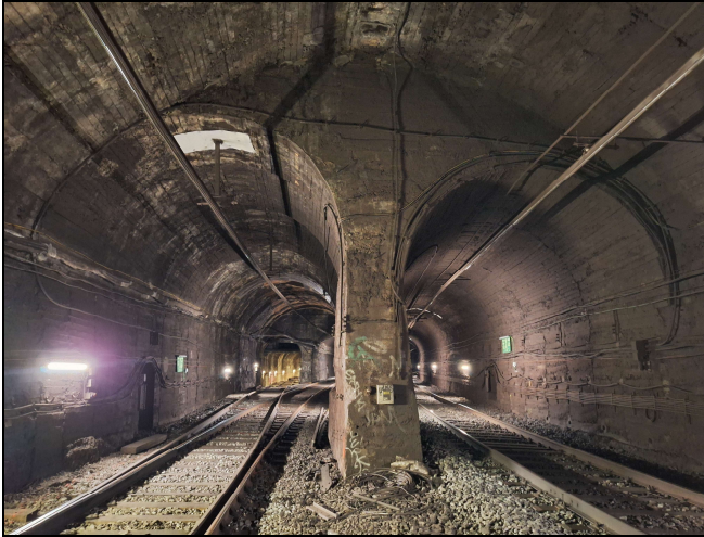
Foto 1: Vista de la secció afectada, via 2 + via 1.
