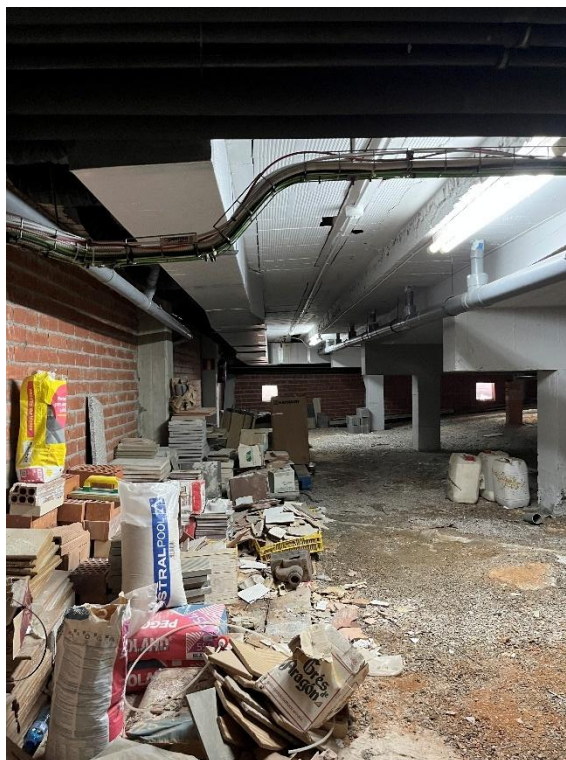
Conducte d'espai tècnic sota vas piscina
