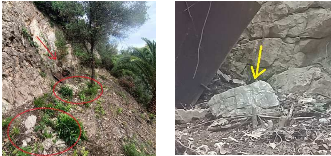
Fig.6: Evidències de lliscaments de falques i caigudes de blocs rocósos.
