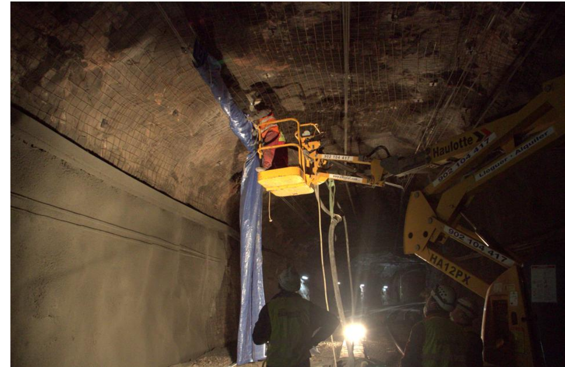
Fotografia 3. Exemple de protecció a la catenària.
