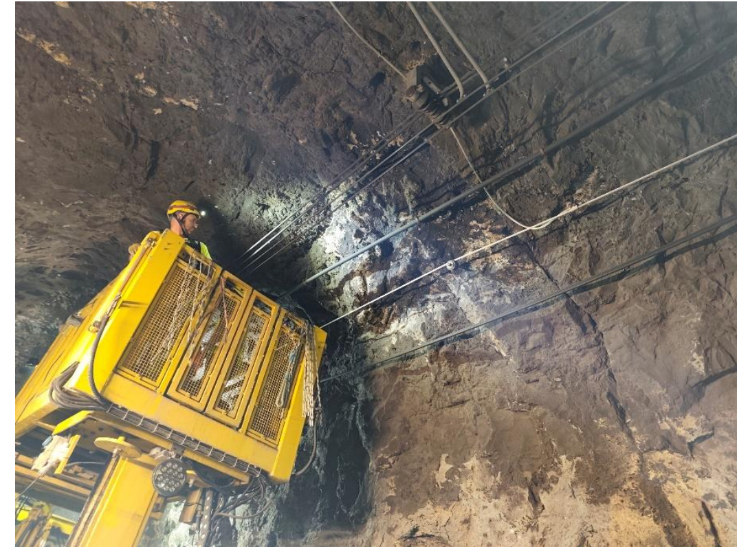
Figura 11. Fragment inestable a la zona sense revestiment Pk 58+855 a 58+875.
