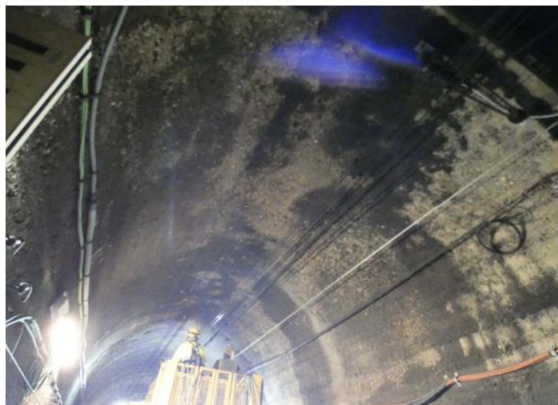
Fotografia PA_002: Lleugera degradació del formigó. PK 58+683
