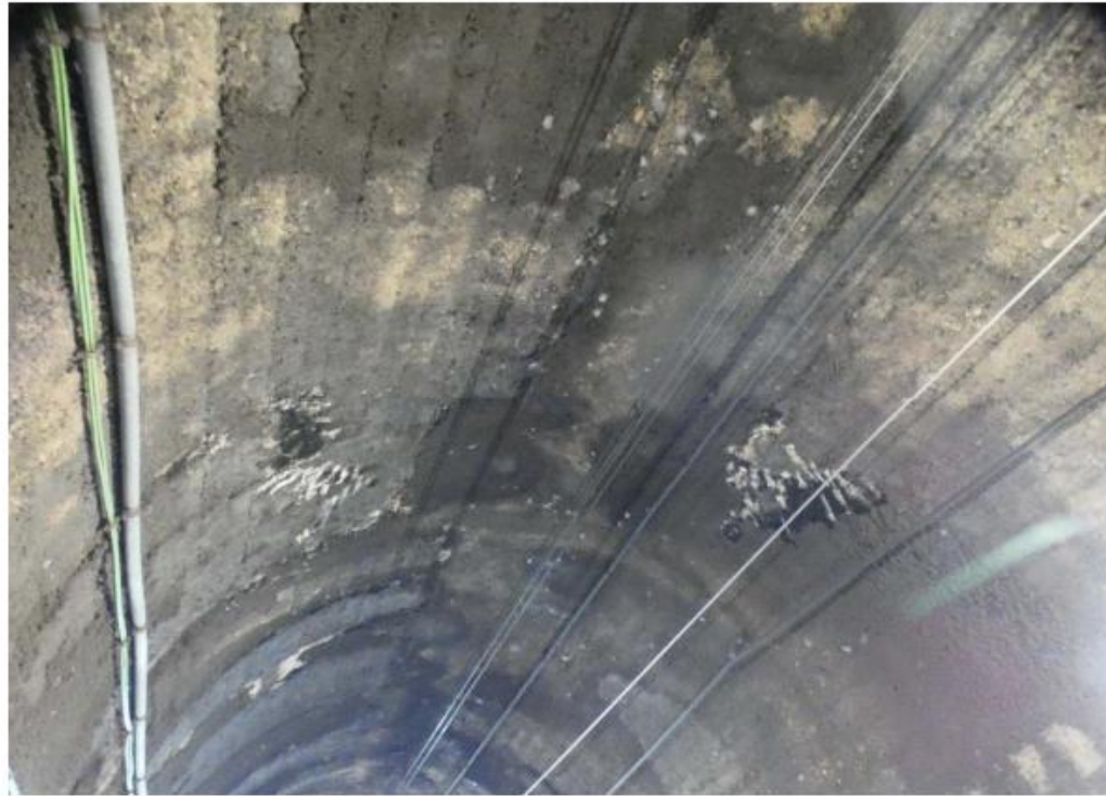
Fotografia PA_005: Concrecions superficials al revestiment de formigó. PK 58+688
