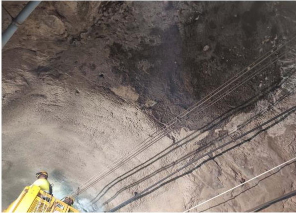
Fotografia PA _009: Detall de la zona de l'alteració de la gunita. PK 58+729
