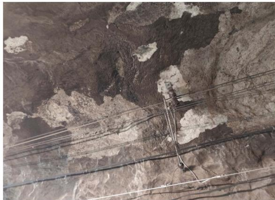
Fotografia PA_016: Pèrdua de la capa de segellat de la gunita . PK 58+773
