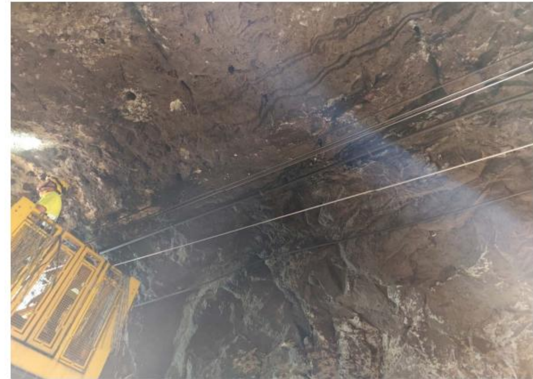
Fotografia PA_024: Vista general de la zona de fragments inestables. PK 58+873
