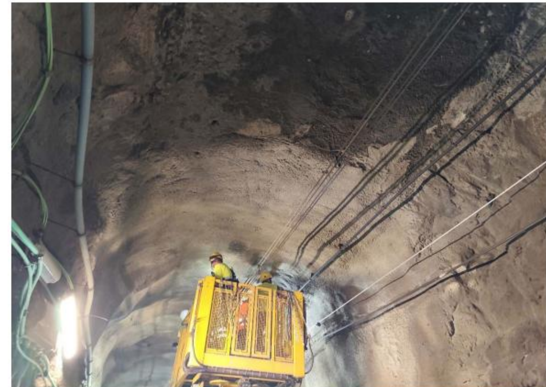
Fotografia PA_008: Vista general de la zona de fragments inestables. PK 58+729
