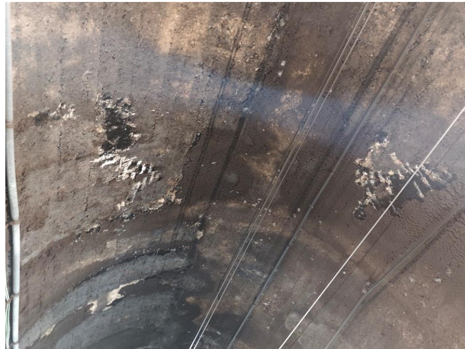
Figura 2. Vista de les zones amb concrecions superficials al revestiment de formigó Pk 58+688.
