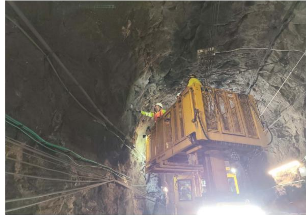
Fotografia PA_007: Vista general de la zona de fragments inestables. PK 58+703
