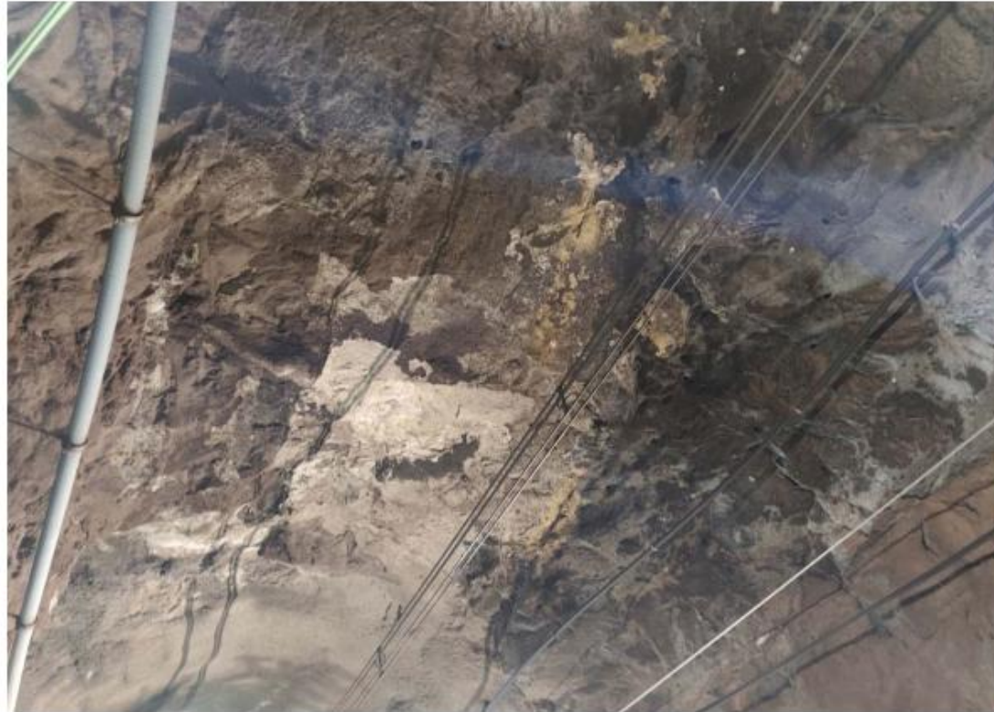
Fotografia PA_011: Pèrdua de la capa de segellat de la gunita . PK 58+748
