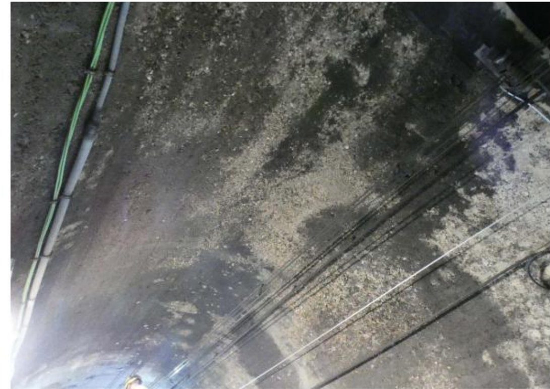
Fotografia PA_003: Lleugera degradació del formigó. PK 58+688
