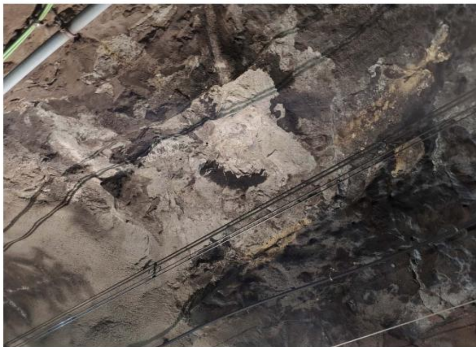
Fotografia PA_012: Detall pèrdua de la capa de segellat de la gunita i zona sanejada. PK 58+748
