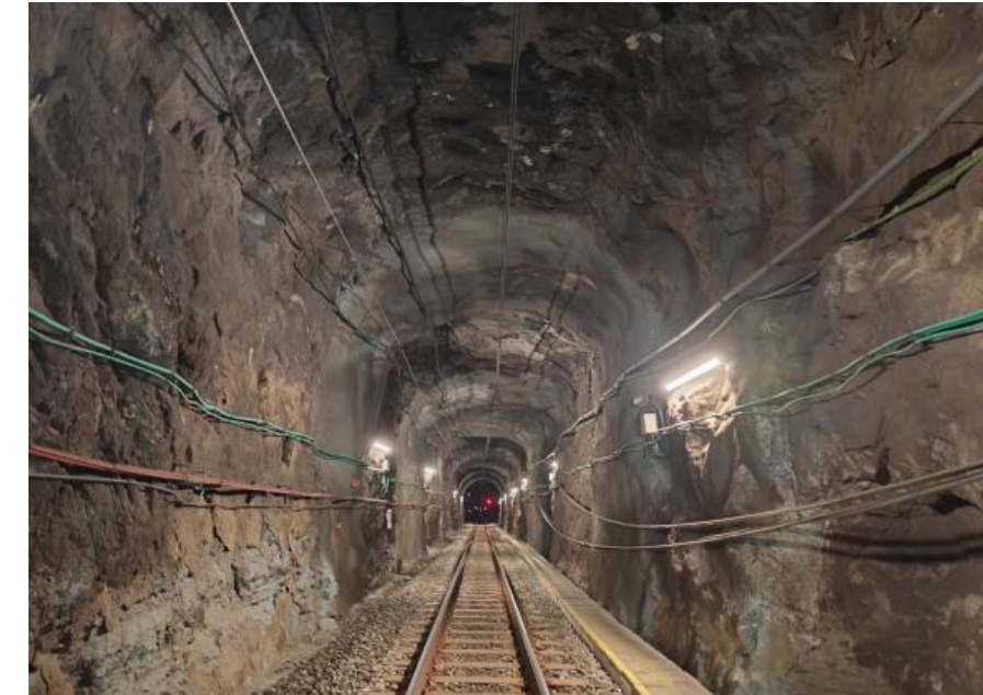
Fotografia 1. Ubicació instal·lacions dins del túnel de Sant Pau.
