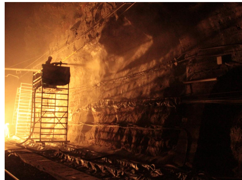
Fotografia 2. Exemple de protecció d'instal·lacions
