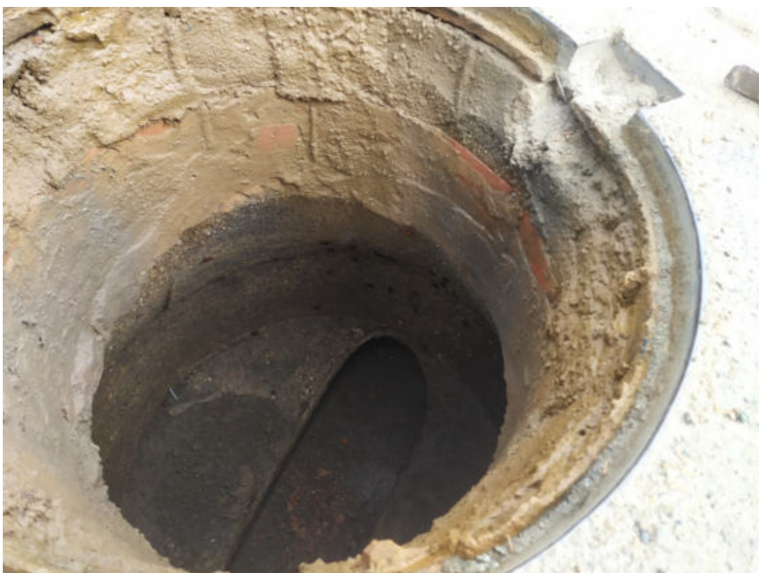
Fotos 13,14,15,16 i 17: Clavegueram del Carrer de la Devesa
