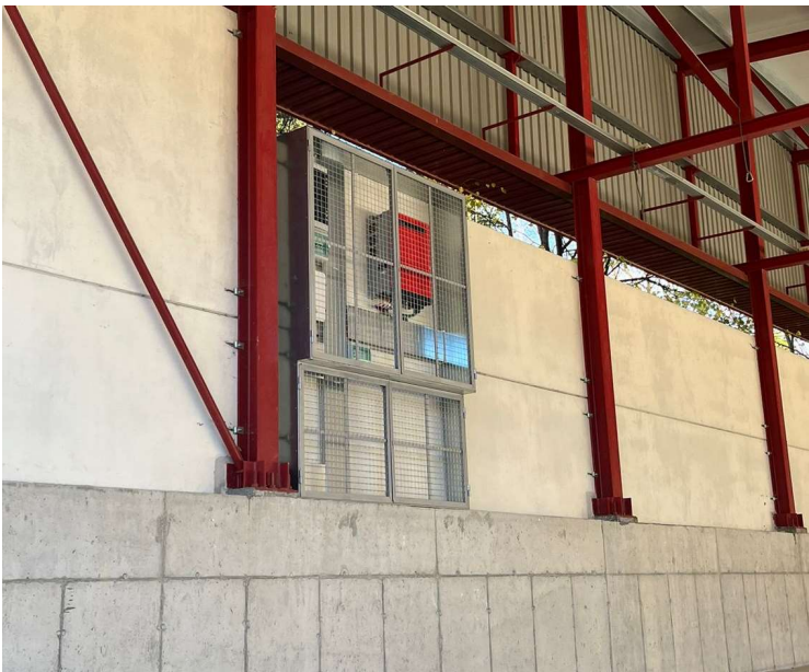
Il·lustració 7. Armari reixat de protecció de l'inversor existent i quadres
