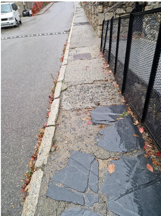
Il·lustració 3: Tram de paviment degradat 3
