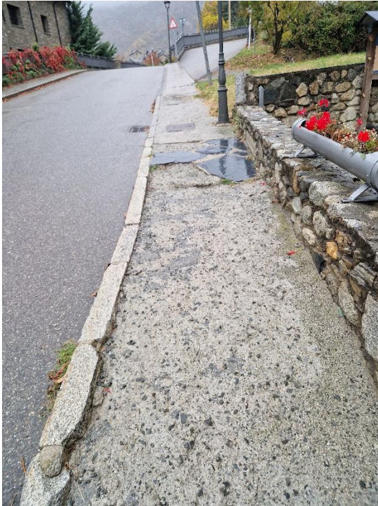
Il·lustració 1: Tram de paviment degradat 1
