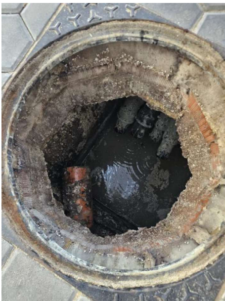
Pou col·lector del carrer, previ al pou de bombes.
