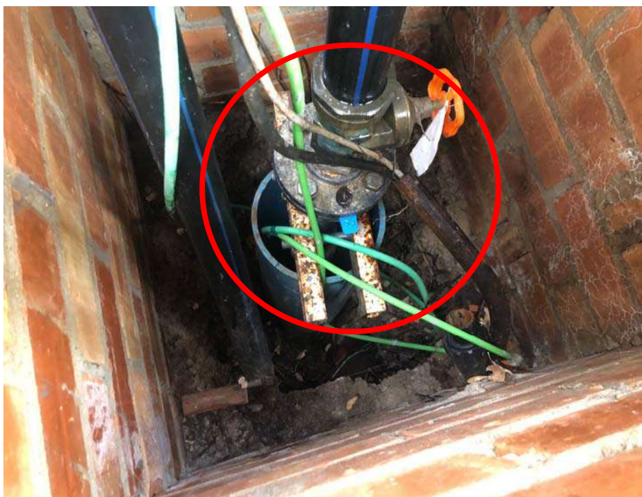
11 Vista interior del pou 2, detall del muntatge hidràulic de sortida (DN-63 mm) del tub de captació de la bomba del pou (instal·lacions fora de servei a substituir).
