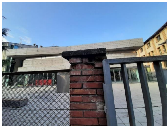
Imatge d'un dels pilars a reparar.
