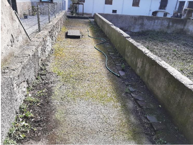
Barana amb el coronament malmès.
