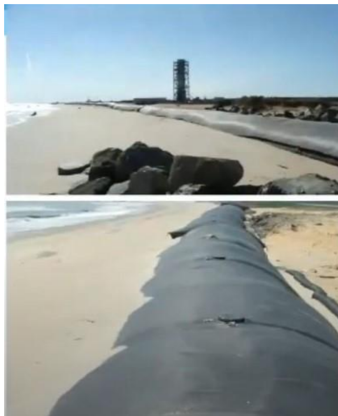
Figura 14. Exemples d'una protecció de geo-tubs sense cap mena de cobertura.
