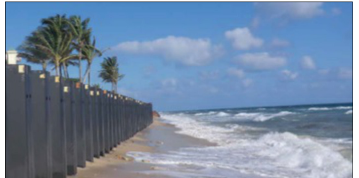
EXEMPLES DE LA UTILITZACIÓ DE PALPLANXES EN LA PROTECCIÓ CONTRA INUNDACIONS I ULTRAPASSAMENTS.
