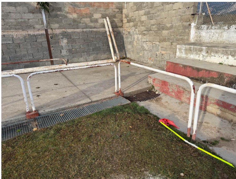
Imatge 14. Reixa corner Nord-Oest filtració d'aigua
