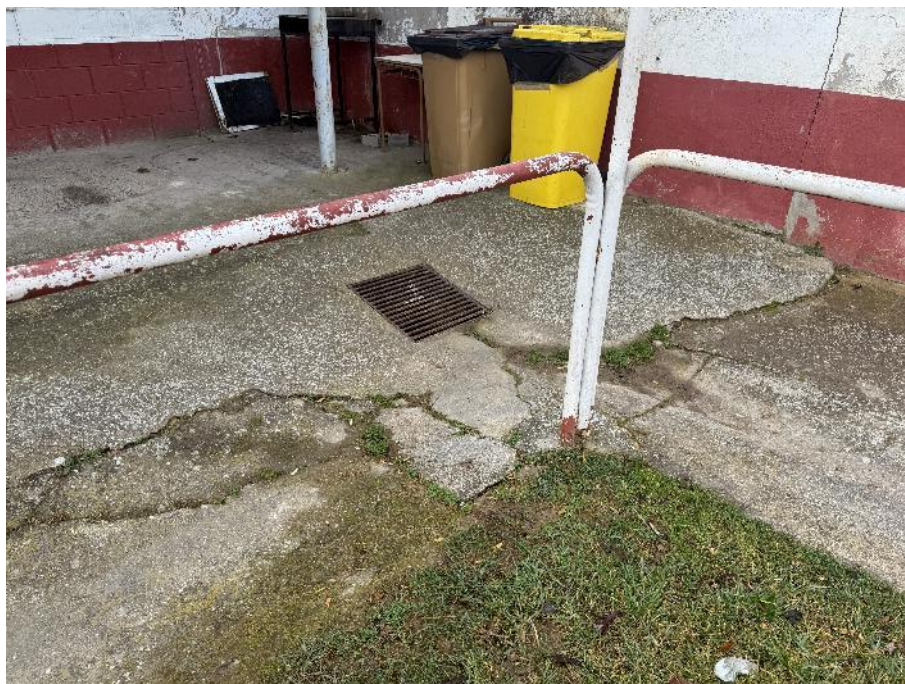
Imatge 12. Reixa corner Sud-Oest filtració d'aigua 01
