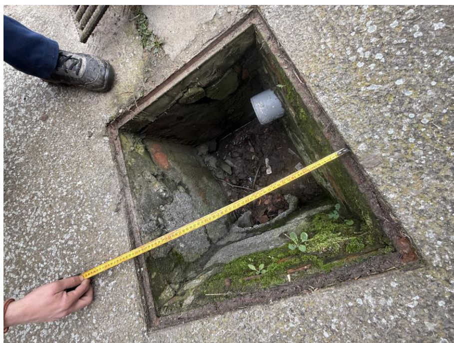
Imatge 13. Reixa corner Sud-Oest filtració d'aigua 02
