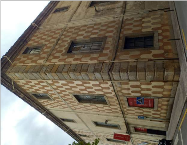
FOTOGRAFIA 12 (CANTONADA NORD-OEST ON SE SITUA EL MAGATZEM I LA UNITAT EXTERIOR DE CLIMATITZACIÓ)
